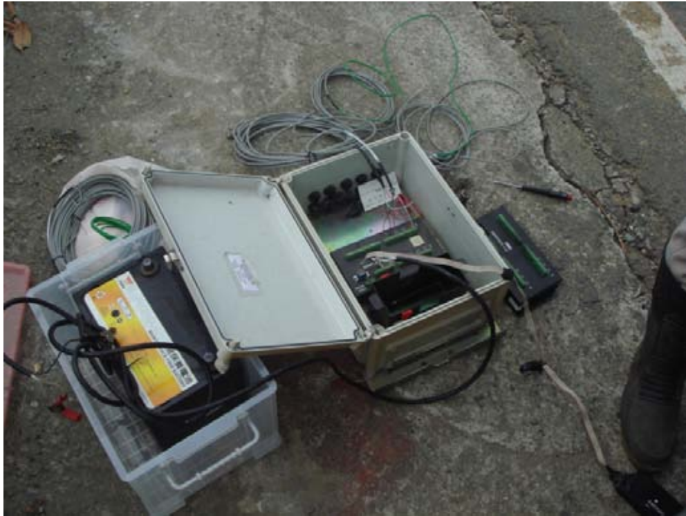
圖 4.1 土壤含水量計之電池與資料接收箱
