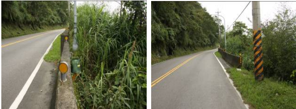
圖 4.16 R-T18-50k+400 雨量站安裝情形
