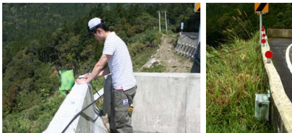
圖 4.20 R-T18-82k+300 雨量站安裝情形
