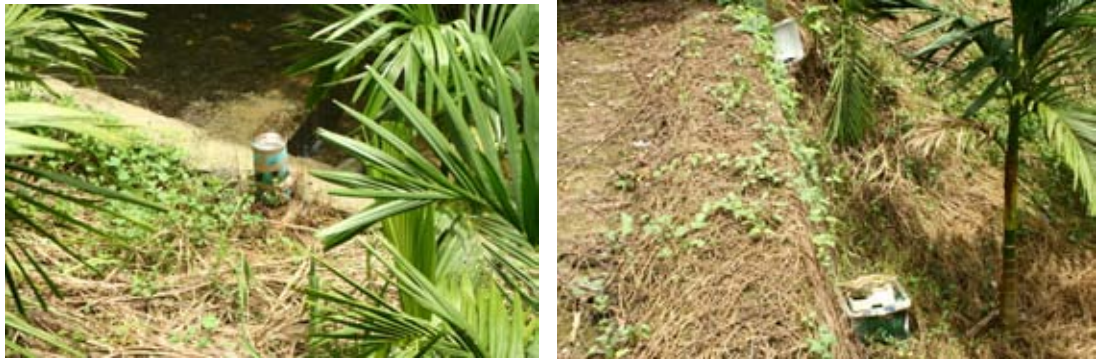
圖 4.13 R-T18-41k+700 雨量站安裝情形
