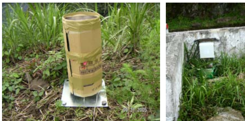
圖 4.18 R-T18-69k+900 雨量站安裝情形
