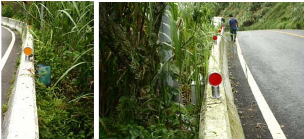
圖 4.17 R-T18-54k+100 雨量站安裝情形
