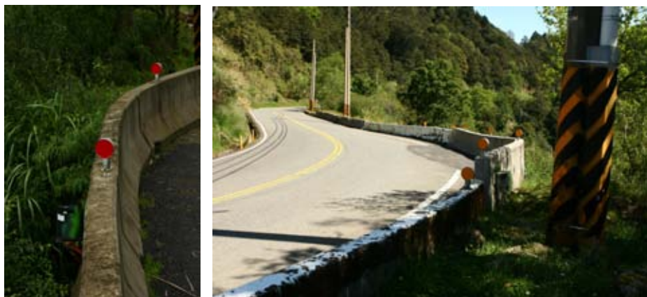
圖 4.24 R-T18-95k+900 雨量站安裝情形
