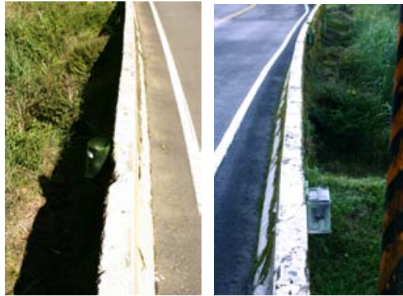
圖 4.22 R-T18-90k+200 雨量站安裝情形
