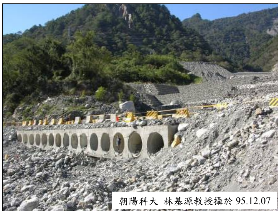
圖 3-35 95.12.07 現地拍攝照片(下邊坡)
