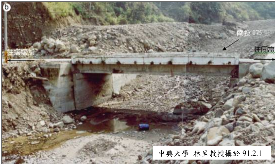
圖 3-69 桃芝颱風愛玉橋在土石清除後由下游往上游拍攝之畫面 資料來源：交通部公路總局，2005
