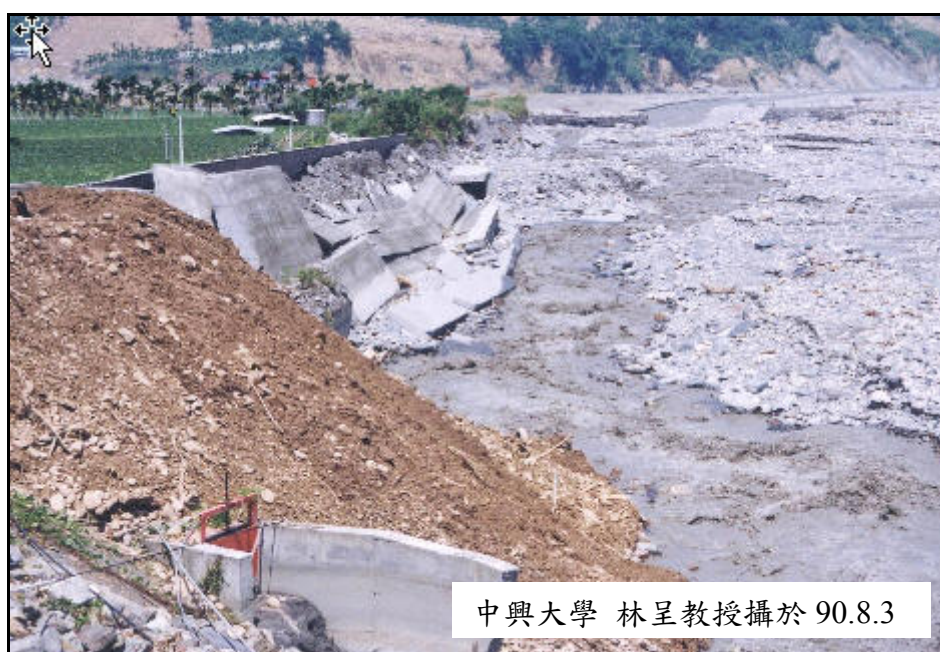
圖 3-43 桃芝颱風期間，下游側堤防址部遭沖刷淘空情況 資料來源：交通部公路總局，2005
