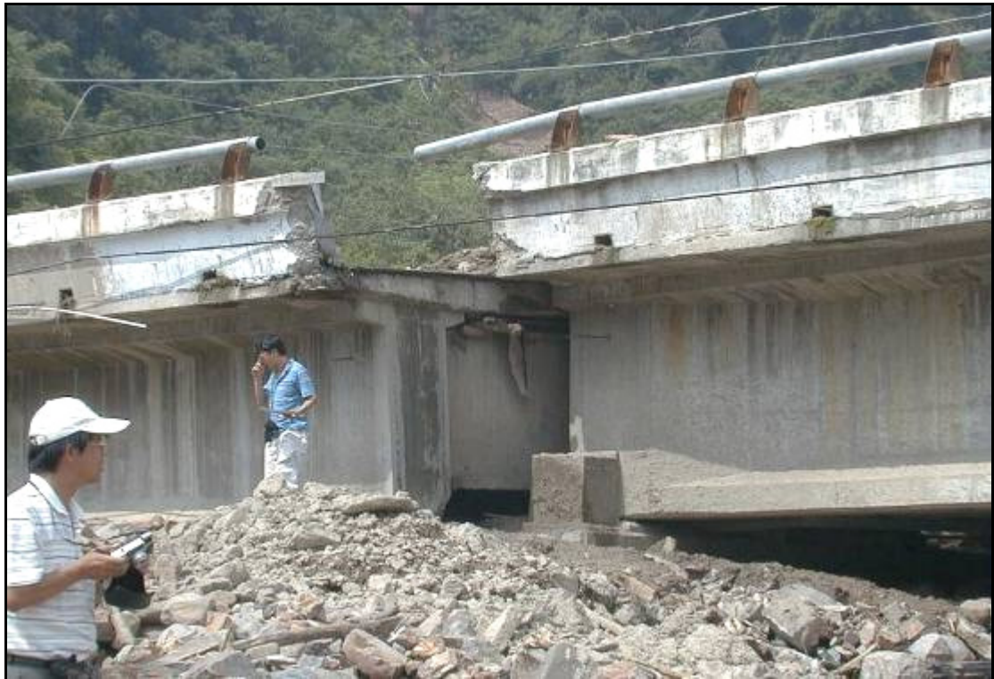
圖 3-55 十八重溪橋上部結構遭推移達兩公尺之情形
