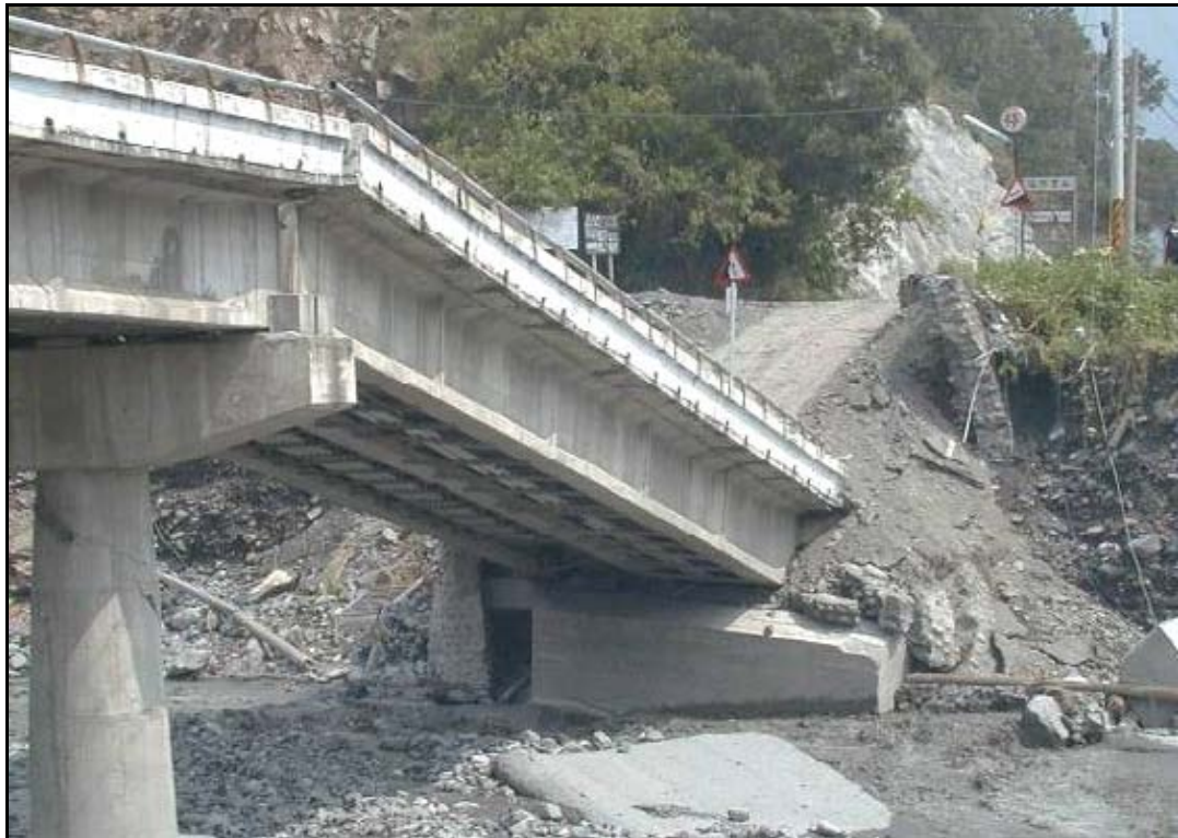
圖 3-59 桃芝颱風過後十八重溪橋南端橋面崩落情形
