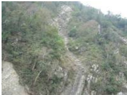
編號 4 號崩塌地現況
