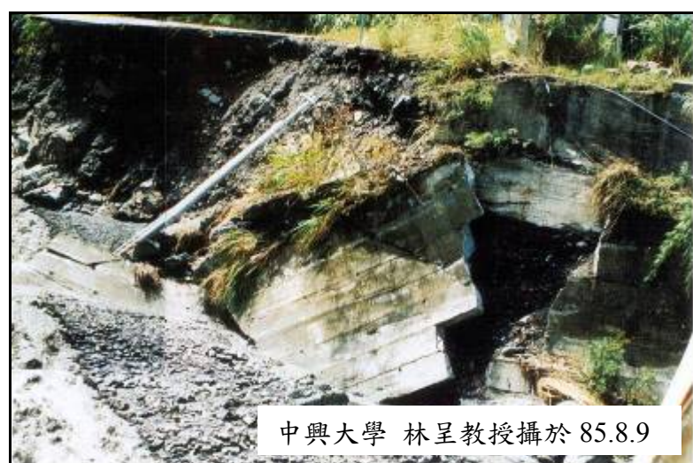
圖 3-57 賀伯颱風期間，十八重溪橋南端橋台上游護岸破壞情形
