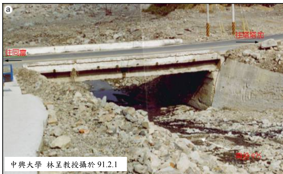
圖 3-68 桃芝風災後愛玉橋橋體及橋台翼牆遭土石流磨蝕的情形 資料來源：交通部公路總局，2005
