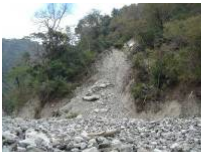
編號 11 號崩塌地現況
