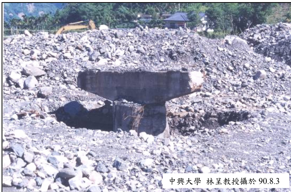
圖 3-42 桃芝颱風後 P1 橋墩墩柱營水面遭土石流撞擊造成鋼筋外露 資料來源：交通部公路總局，2005
