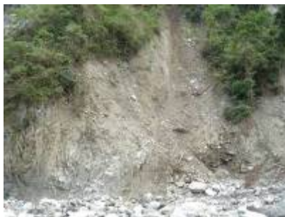
編號 8 號崩塌地現況
