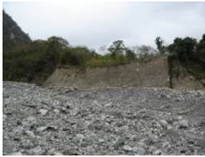
編號 2 號崩塌地現況
