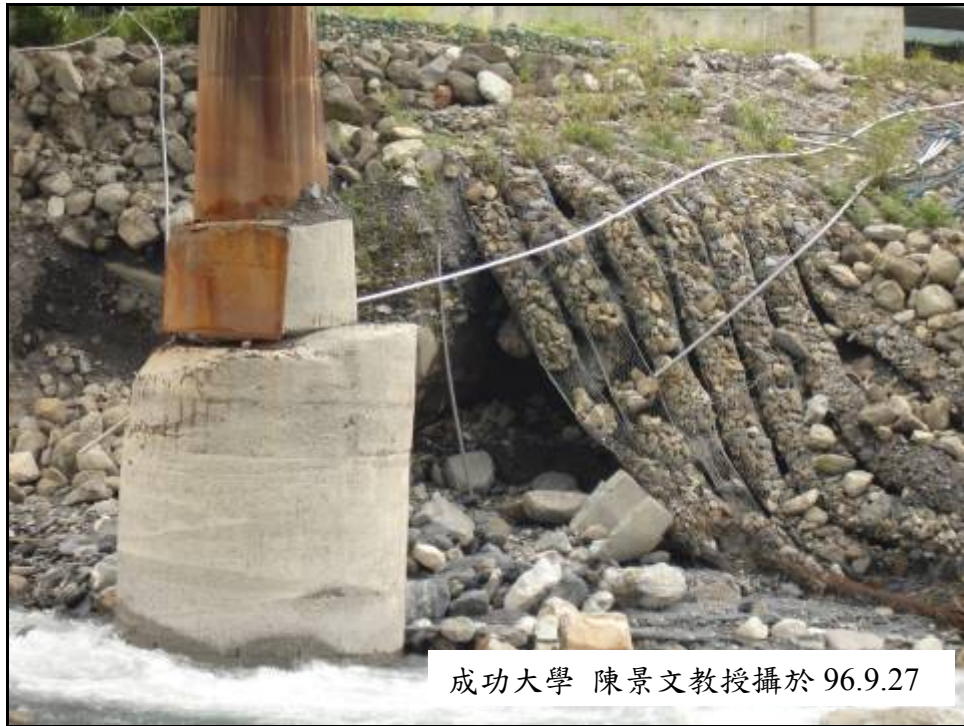
圖 3-61 石籠堤防受土石、洪水流破壞
