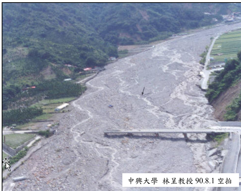
圖 3-41 桃芝颱風期間，信義橋第一、二跨橋面流失情形 資料來源：交通部公路總局，2005
