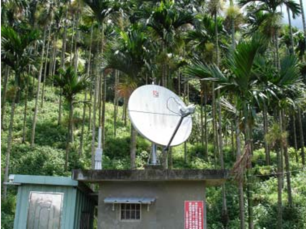
圖 3-19 台 18 線 45K 自動化監測儀器小屋
