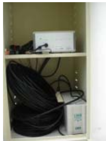
圖 3 - 5 儀器設備箱內部設備情況
