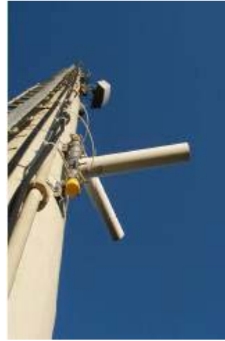
圖 2 - 24 無線通訊設備
