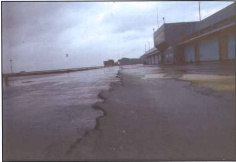
照片 3.1 民國 75 年地震造成蘇澳港 4-5 號碼頭後線下陷龜裂 500 公尺(溫國樑教授提供)
