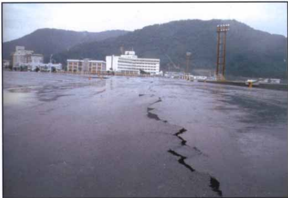
照片 3.2 民國 75 年地震造成蘇澳港 4-5 號碼頭後線下陷龜裂 500 公尺(溫國樑教授提供)
