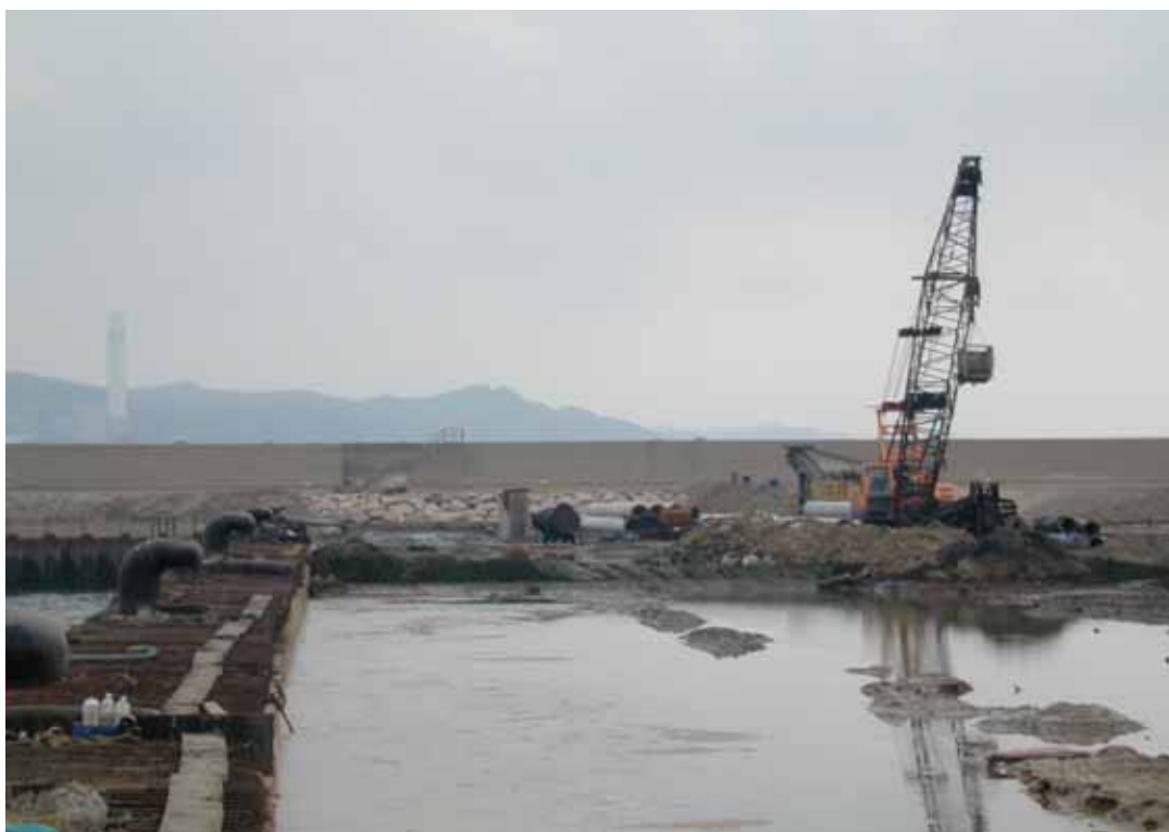
照片 7-4 E14 碼頭法線冠牆中段凸出(向 E13 縮弧)
