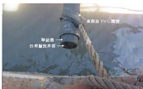
照片 3-2 第 82 號上層拉桿斷脫照片(一)
