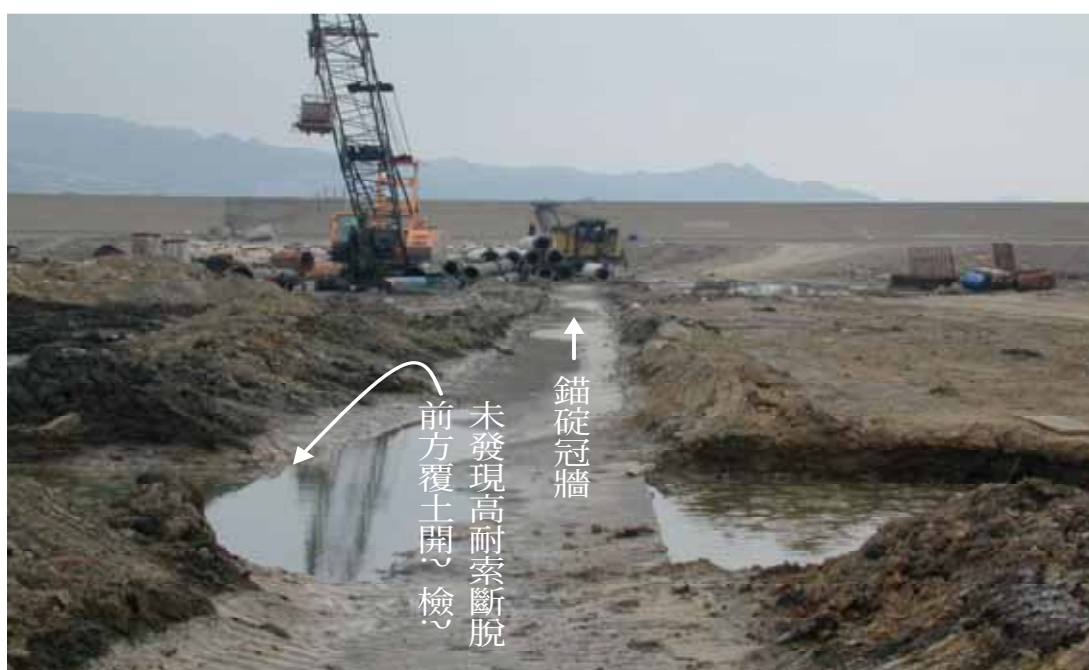
照片 7-5 錨碇冠牆向海側傾斜位移
