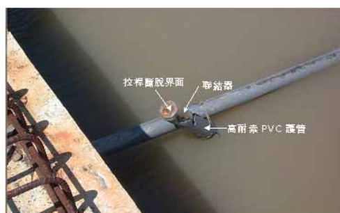
照片 3-3 第 88 號下層拉桿斷脫照片(二)
