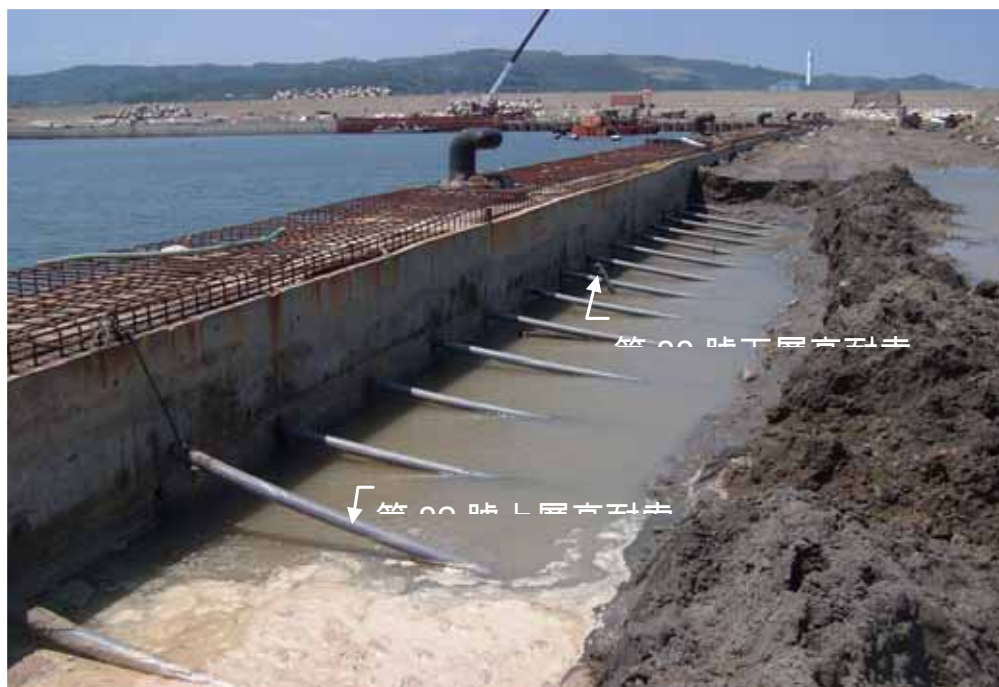
照片 7-2 施工時第 81~88 號下層高耐索斷落，碼頭側移 70 多公分
