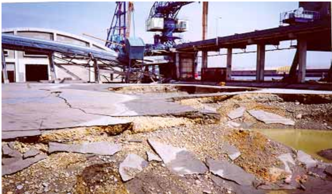
照片 3.3 民國 88 年 921 地震，臺中港 1 號碼頭後線背填土之砂液化流失，造成約 4-5m 深之大坑洞，地表並留下約 10cm 厚之噴砂
