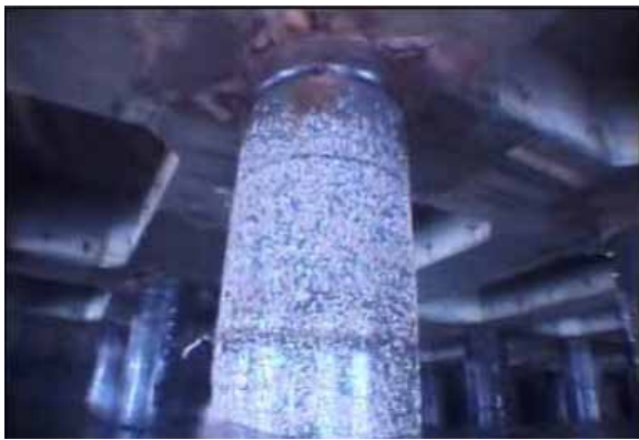
圖 2.15 海水面上鋼管樁表面
