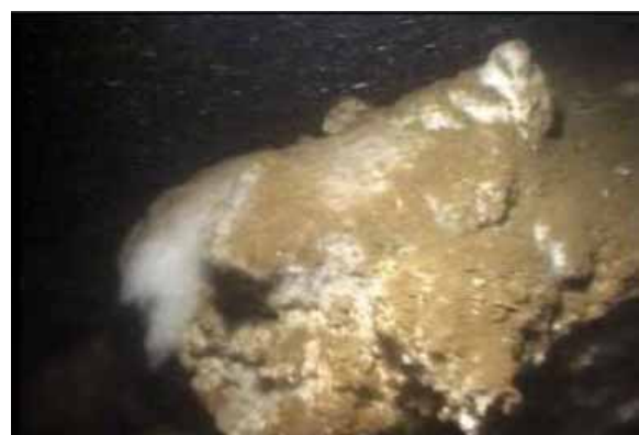
圖 2.19 海床底部陽極塊表面淤泥
