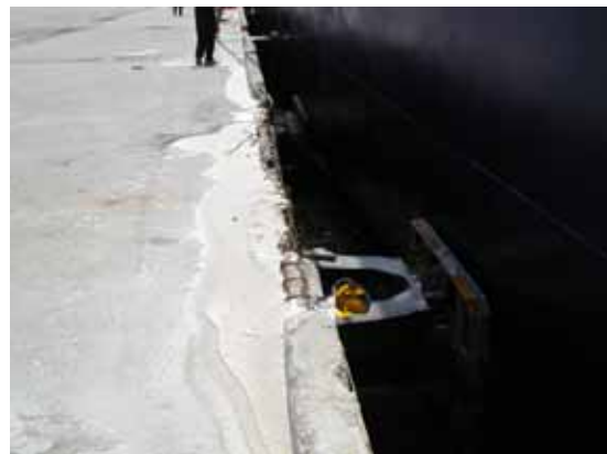
b. 碼頭岸肩及檔車牆現況
