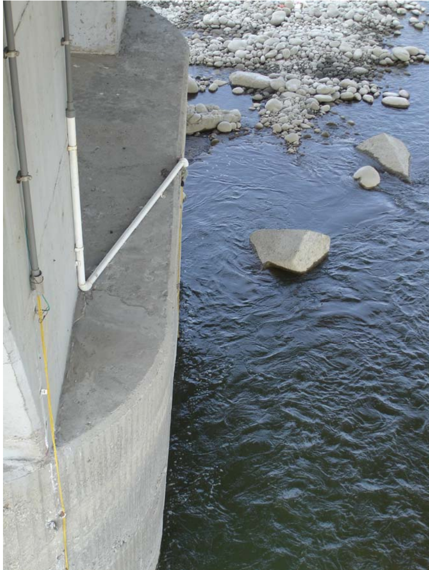
圖 4.39 現場損壞勘查
