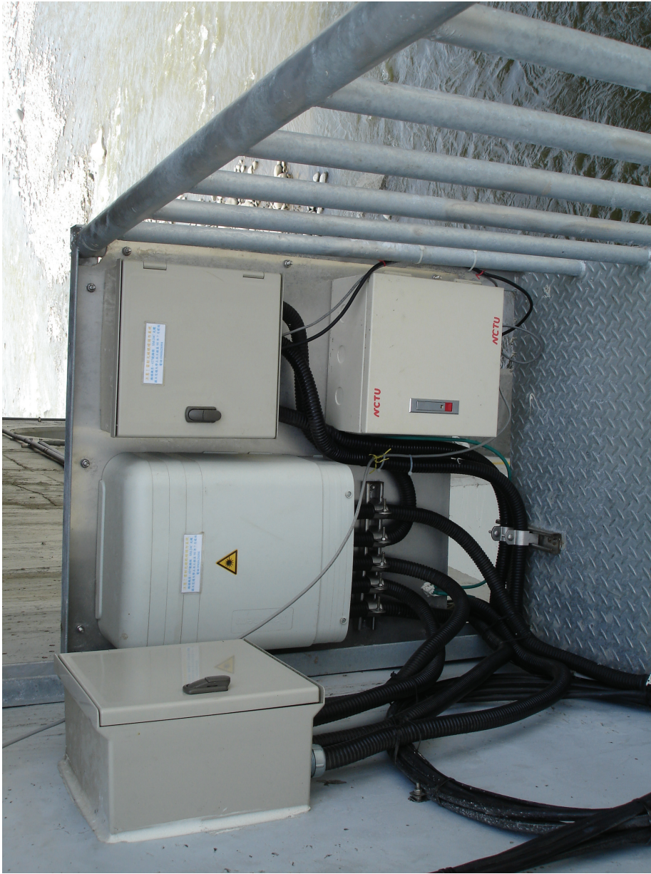
圖 3.28 現場擷取與傳輸系統完成圖
