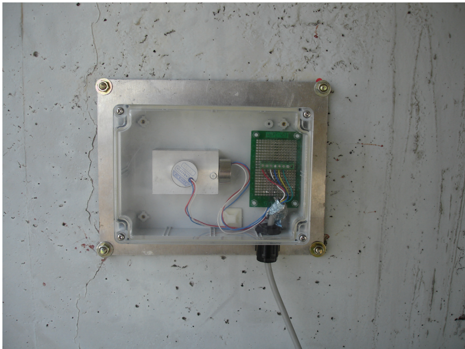
圖 3.23 測傾/加速度計安裝完成圖
