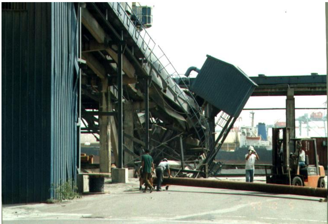
圖 3.4 921 臺中港裝卸設施災損情形
