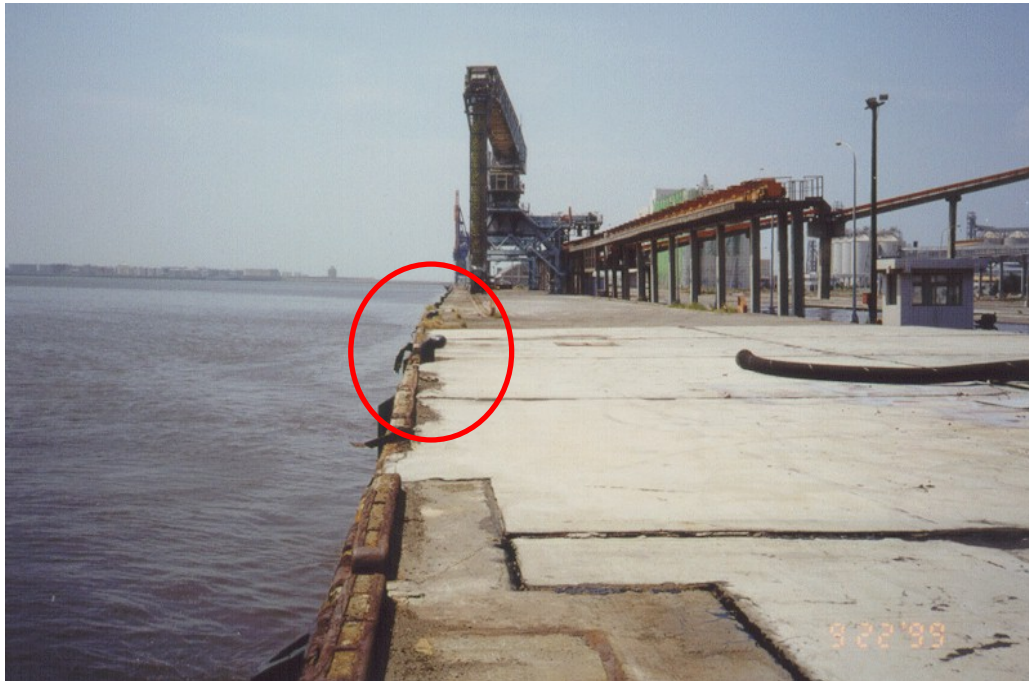
圖 3.1 #1~#4 沉箱式碼頭法線變位側視圖
