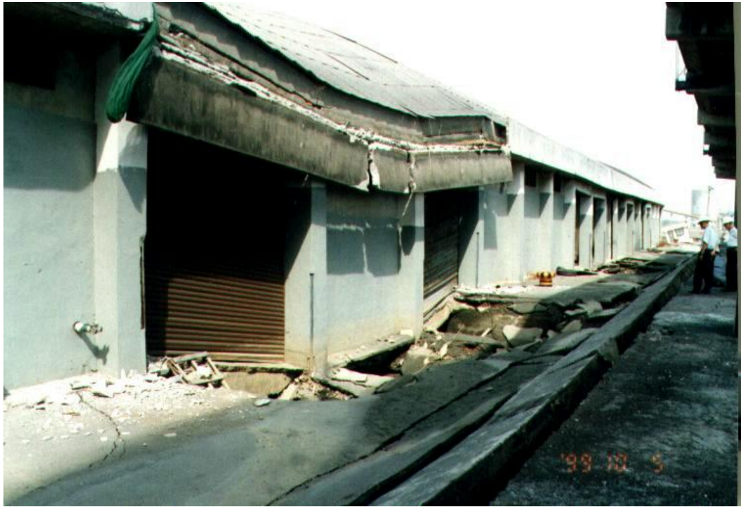
圖 3.5 921 臺中港倉儲設施災損情形
