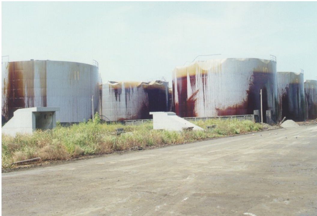
圖 3.6 921 臺中港儲槽災損情形
