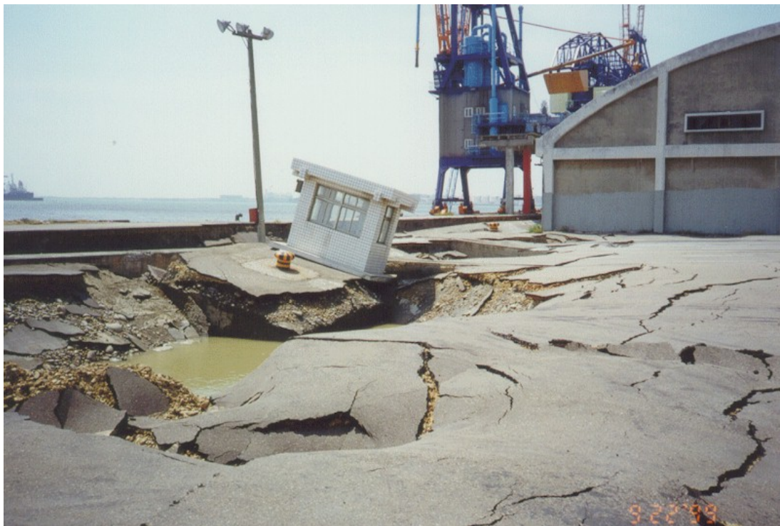
圖 3.3 #1~#4 沉箱式碼頭後線災損情形
