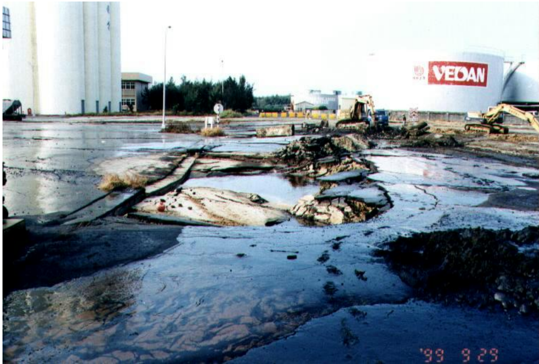
圖 3.7 921 臺中港糖蜜儲槽災損情形
