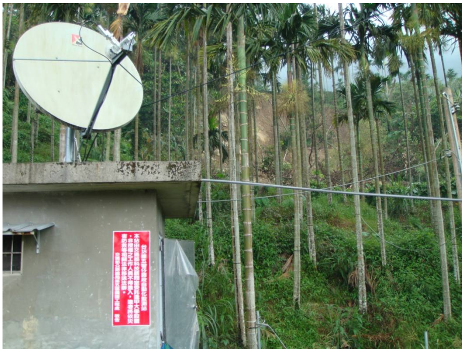
圖 3-10 儀器屋上方崩塌
