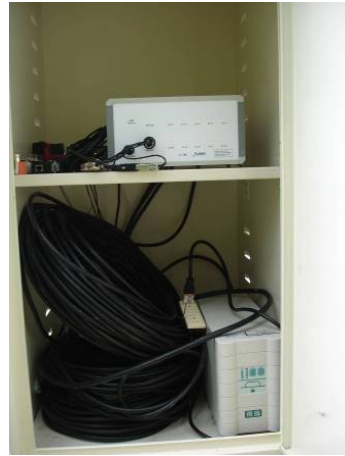
圖 4-3 儀器設備箱內部設備情況
