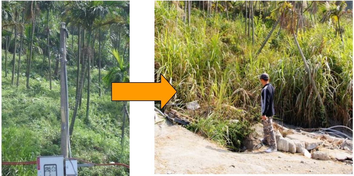
圖 2-11 GPS3 天線及自立桿被施工單位拆除現況
