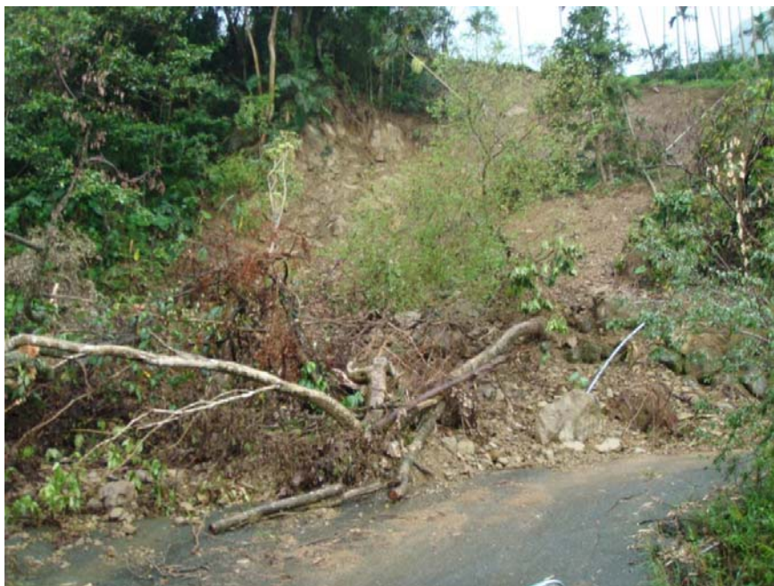
圖 3-11 儀器屋上方崩塌近照
