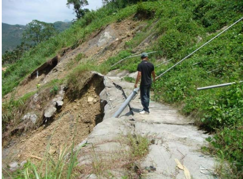
圖 3-14 GPS8 基座崩塌
