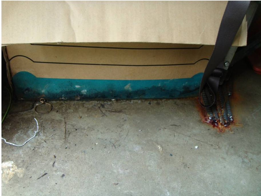
圖 3-9 儀器屋淹水痕跡
