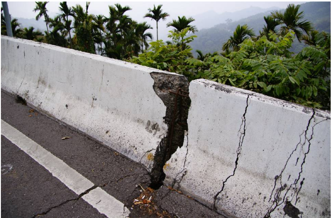
圖 5-17 台 18 第二彎護欄及路面龜裂現況照片
