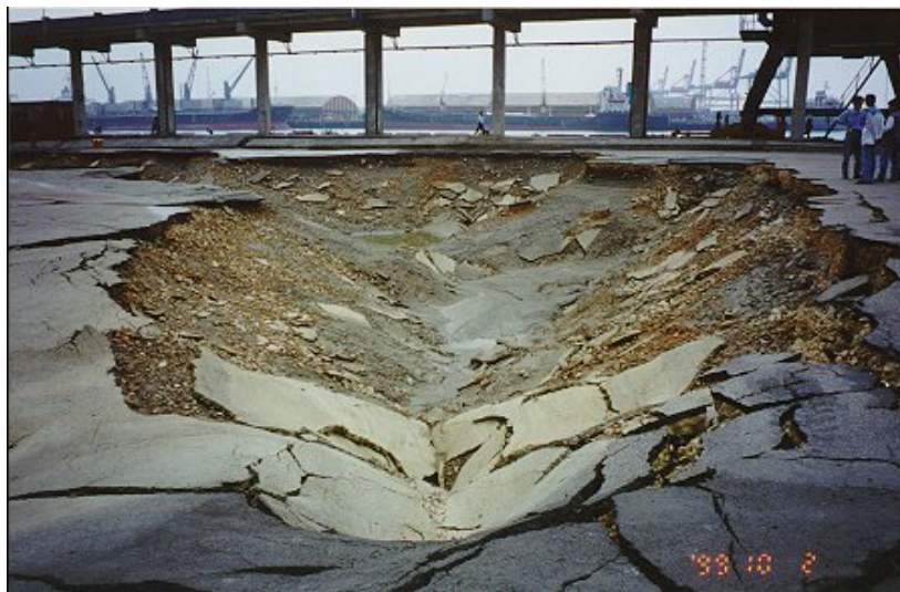
圖 1-2 臺中港 1 至 4A 碼頭內災損情況
