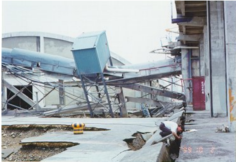
圖 1-3 臺中港倉儲輸送設備災損情況
