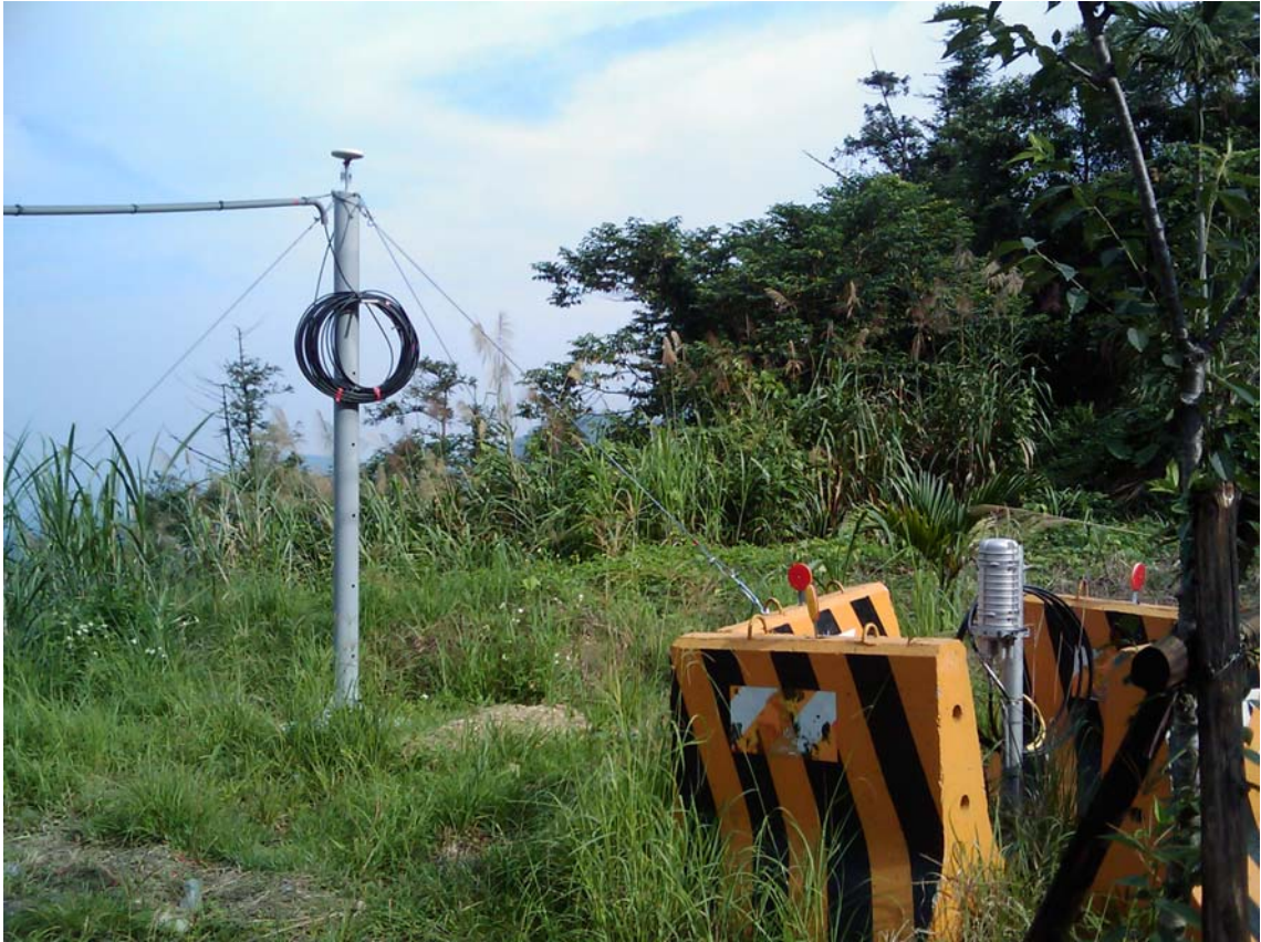
圖 2.4 IHMT-01 監測孔位旁之 GPS 監測站
