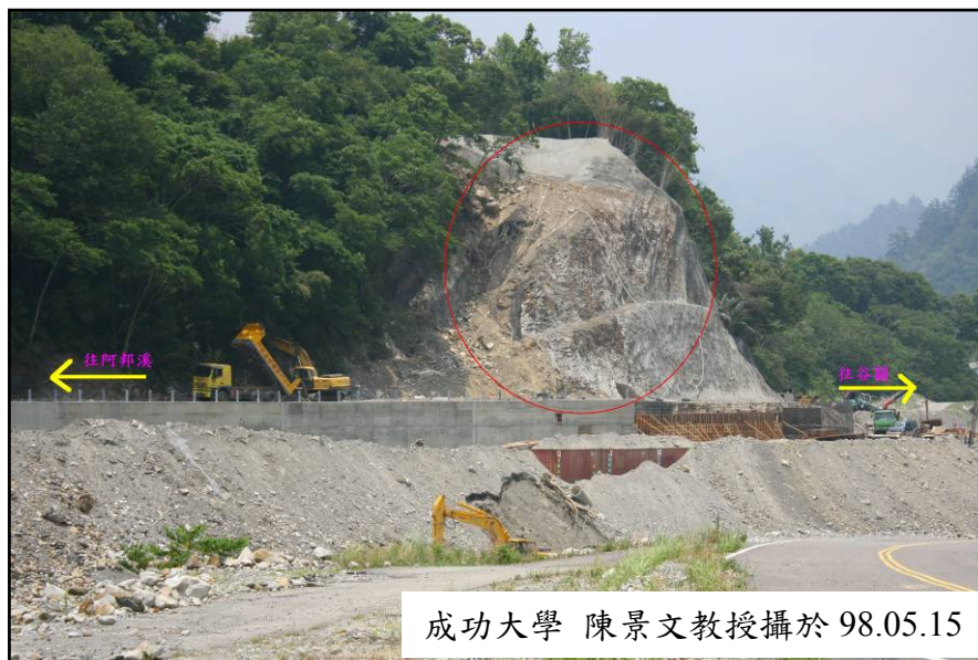
圖 4.85 98.5.15 現地拍攝照片(台 8 縣路基崩塌)
