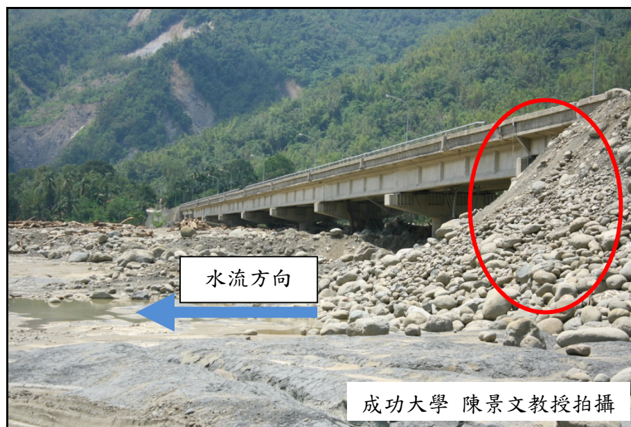
圖 5.6 台 21 線 235K+585 楠梓仙溪橋左側橋台後方河道漫流
