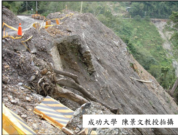
圖 6.7 下邊坡產生沖刷（蝕）型破壞
