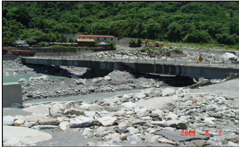
圖 6.23 橋梁受土石災害撞擊實例(李維峰，2008)
