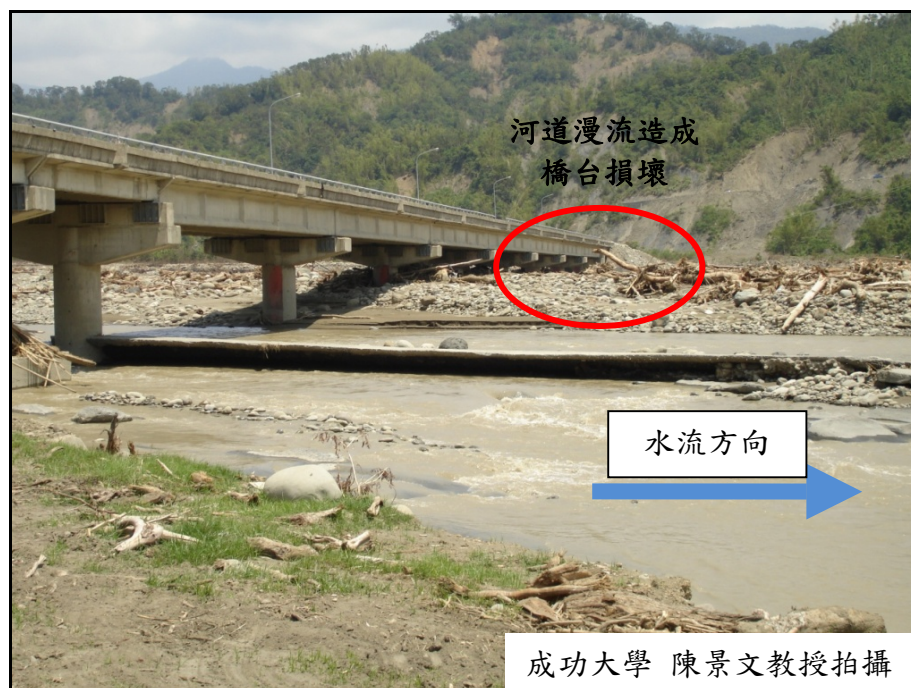
圖 5.5 台 21 線 235K+585 楠梓仙溪橋左側橋台後方河道漫流
