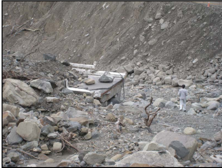
圖 6.26 因土石流撞擊、溢流損害橋梁(李維峰，2009)
