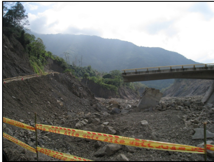
圖 6.25 邊坡崩塌損害橋梁
