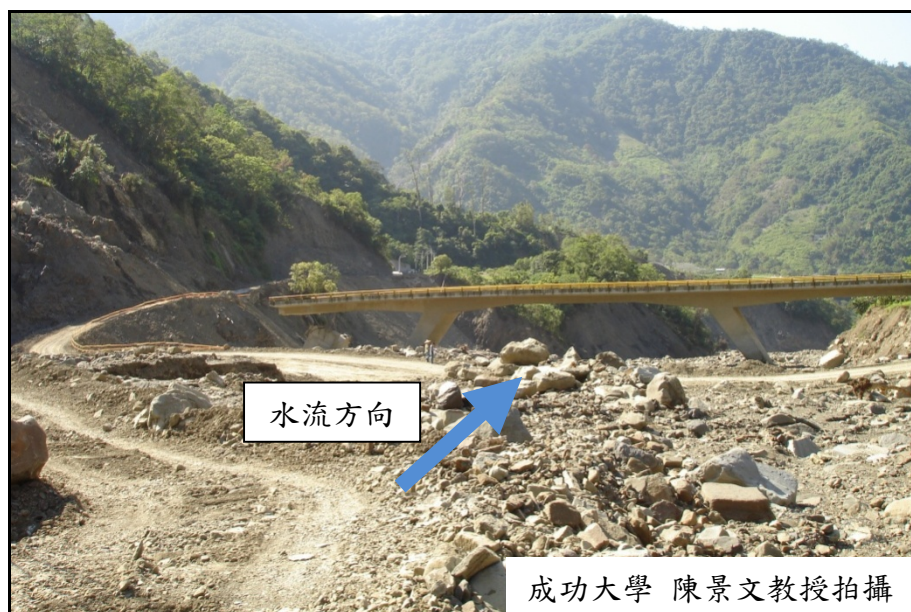
圖 5.16 台 20 線 87K+300 塔拉拉魯芙溪橋左側橋台損毀
