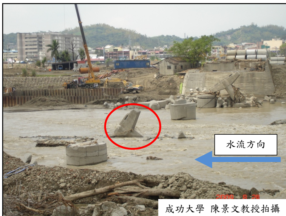
圖 5.2 台 28 線 30K+500 旗尾橋橋墩傾倒破壞
