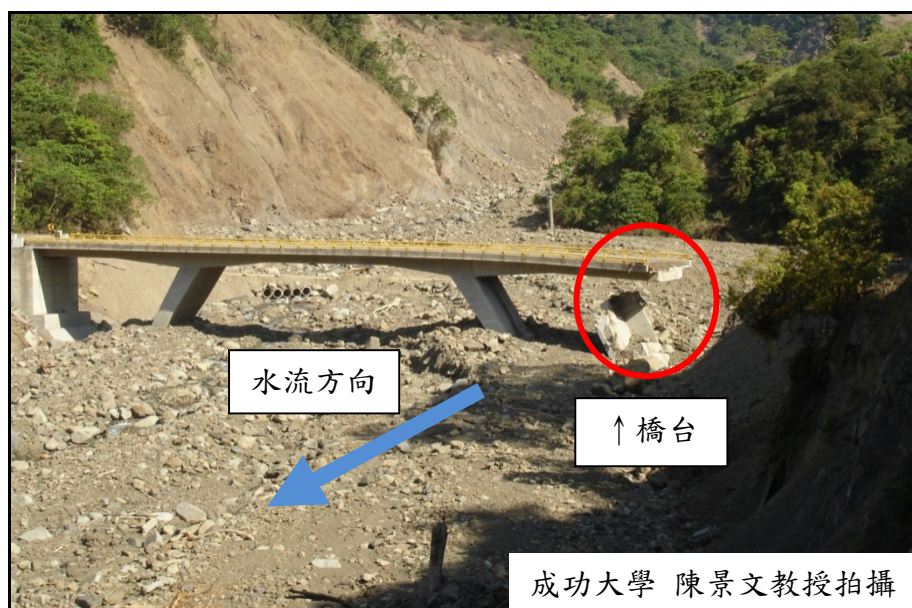
圖 5.15 台 20 線 87K+300 塔拉拉魯芙溪橋左側橋台損毀
