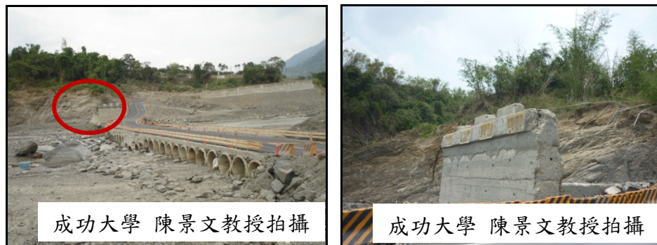
圖 6.34 新發大橋右岸橋台破壞情形
