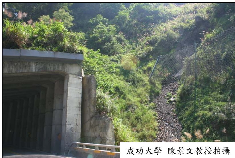
圖 6.15 台 8 線之明隧道前之立式防落石網
