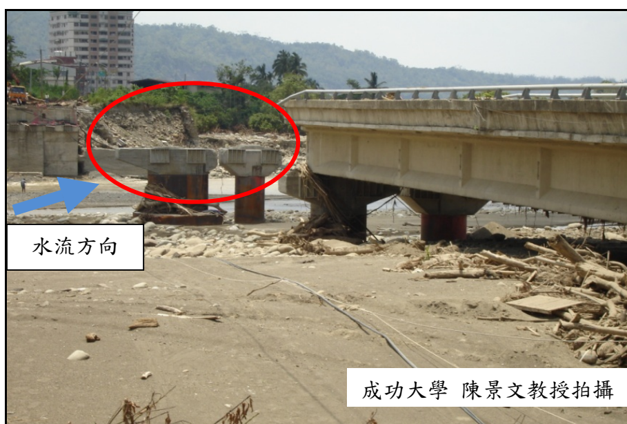
圖 5.3 台 21 線 236K+650 四德橋橋面落台
