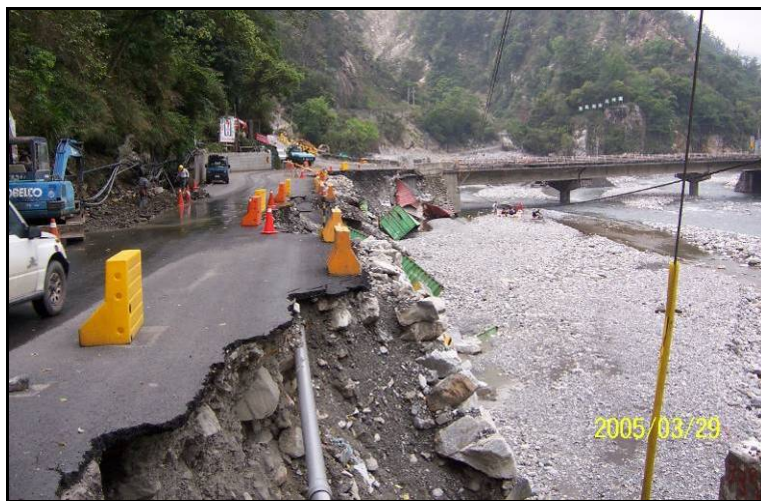
圖 6.24 橋梁橋台護岸受河床堆高後水流攻擊破壞實例(李維峰，2008)
