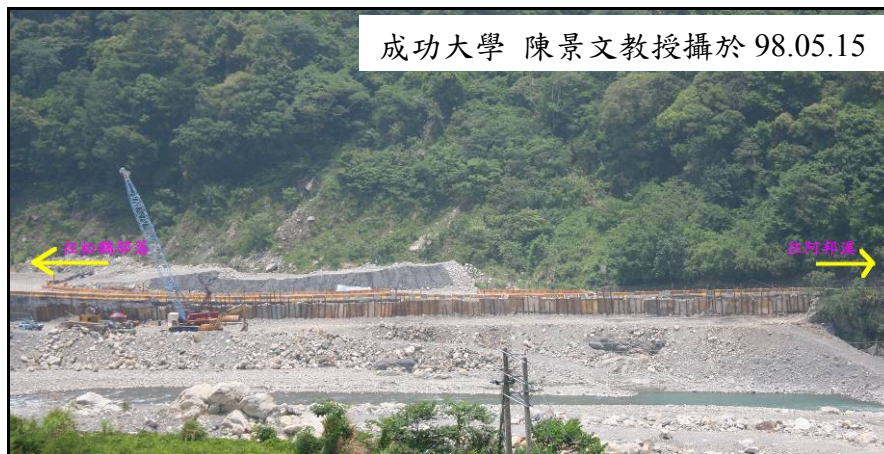
圖 4.84 98.5.15 現地拍攝照片(台 8 縣路基崩塌)
