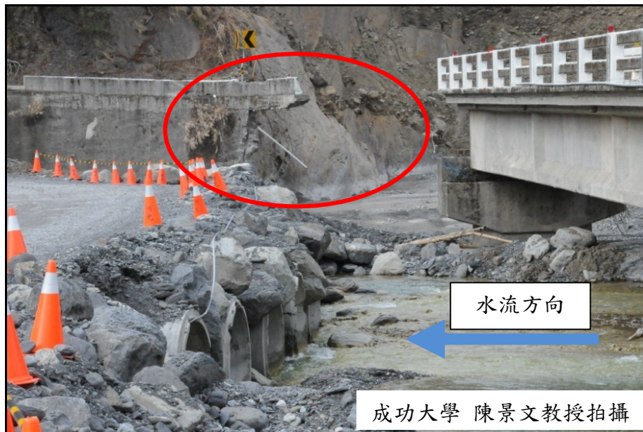
圖 5.4 台 20 線 103K+360 復興橋橋台後方遭淘刷破壞
