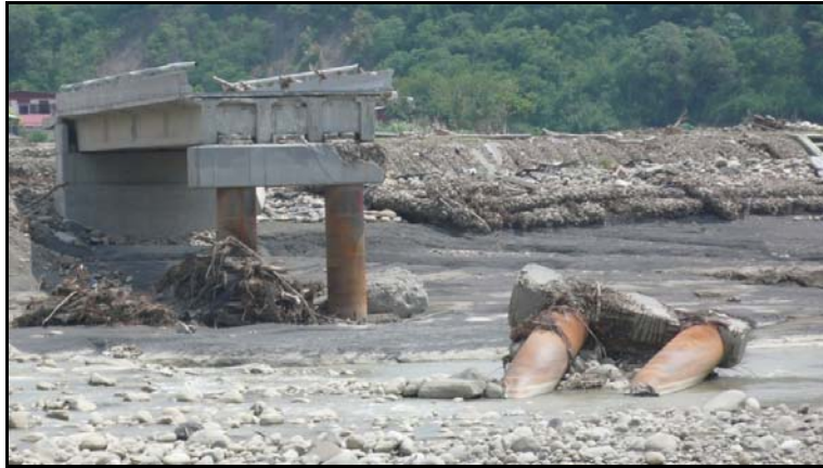
圖 6.30 因基礎淘刷而損害的橋梁(李維峰，2009)
