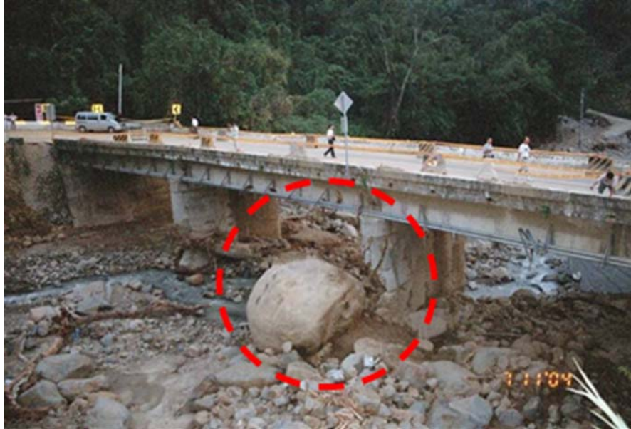
圖 5.7 橋墩受土石流巨礫撞擊破壞之實景
