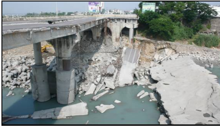
圖 3.15 冲刷造成之沉箱基礎損壞(李維峰，2008)
