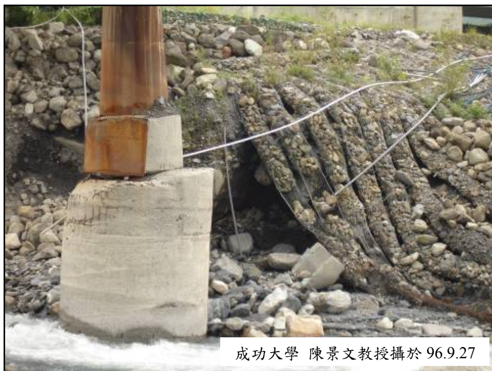
圖 4.3 石籠堤防受土石、洪水流破壞
