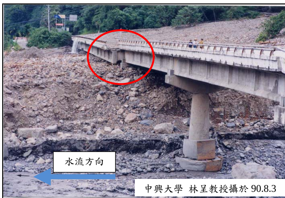
圖 5.12 台 21 線 98K+070 十八重溪橋土石堆積推擠橋面版
