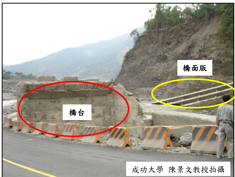
圖 5.9 台 27 線 3K+480 新發大橋右側橋台翻覆
