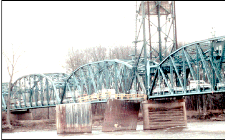
圖 3.17 沖刷導致基礎滑移破壞情形(李維峰，2008)
