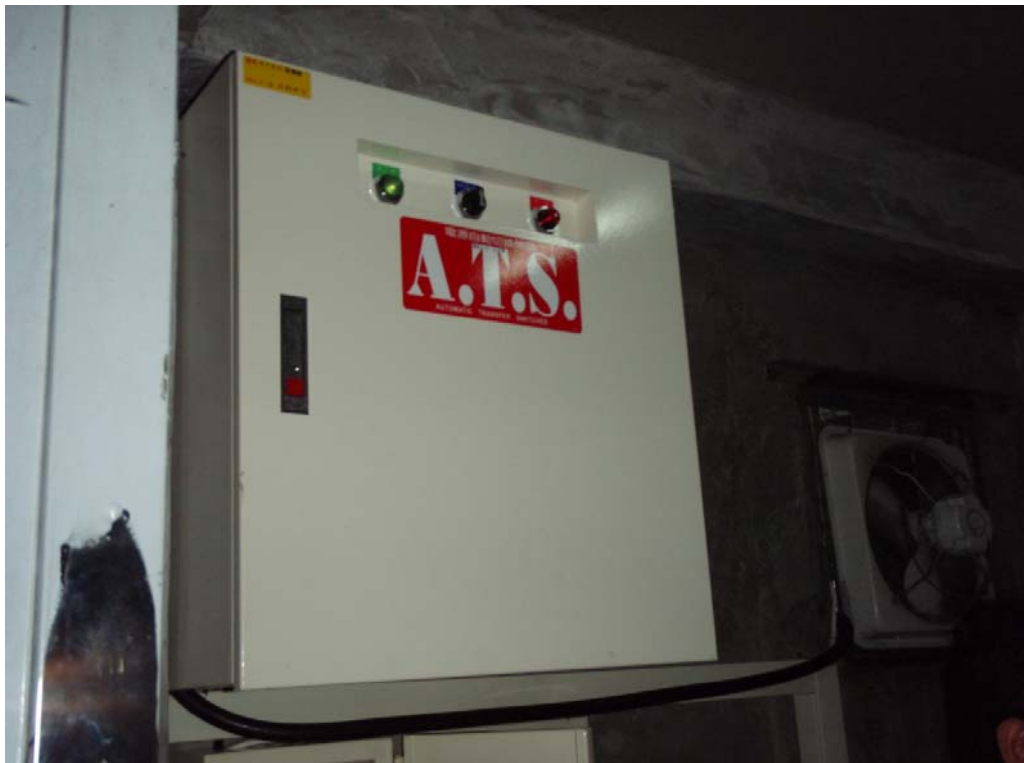
圖 3.16 電源自動切換器(ATS)
