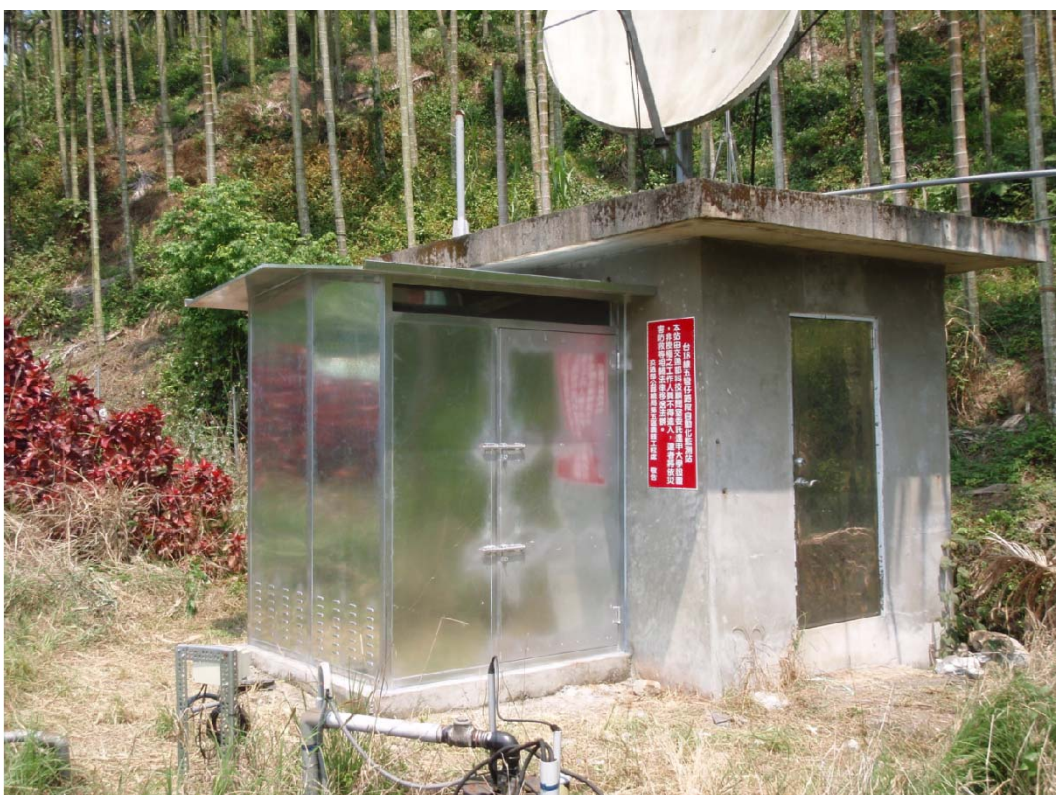
圖 3.15 發電機房完工照片
