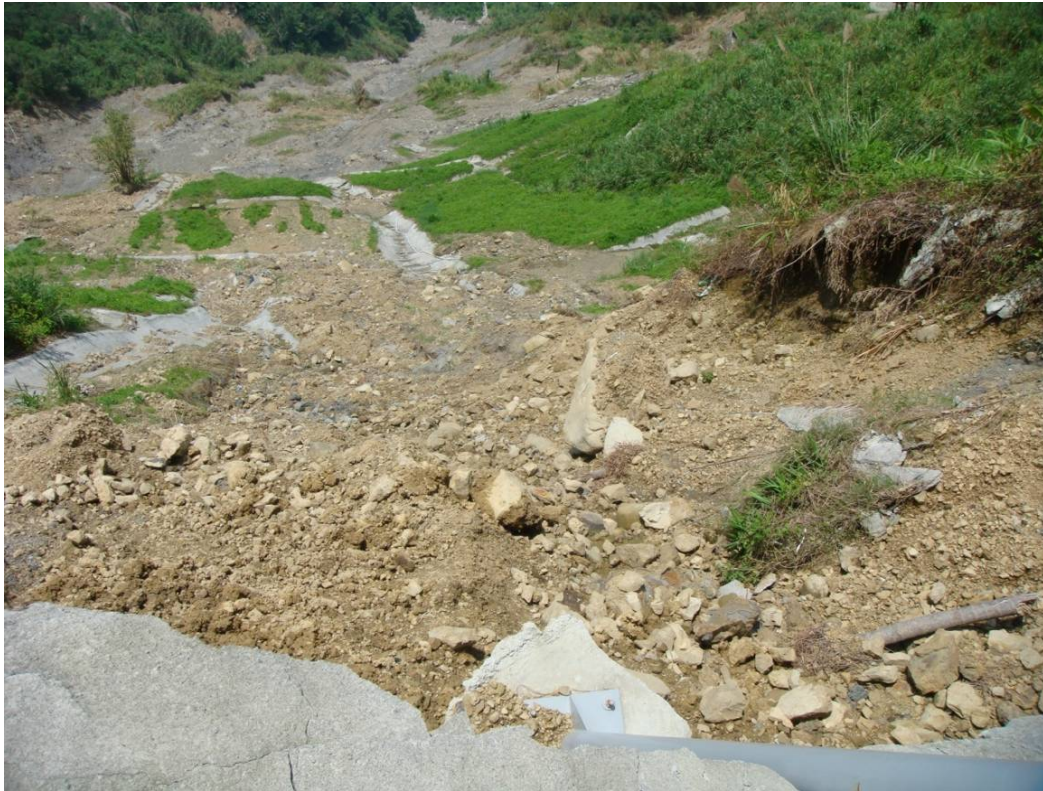
圖 3.4 GPS 監測區災後崩塌
