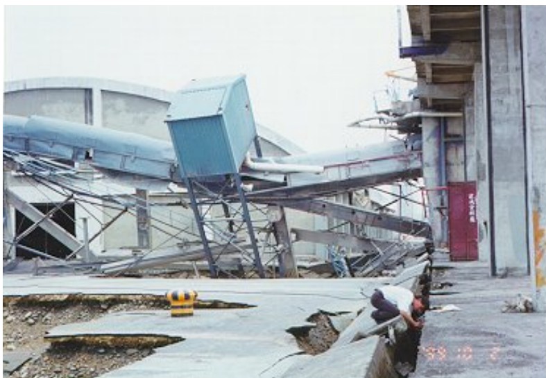
圖 1.3 臺中港倉儲輸送設備災損情況
