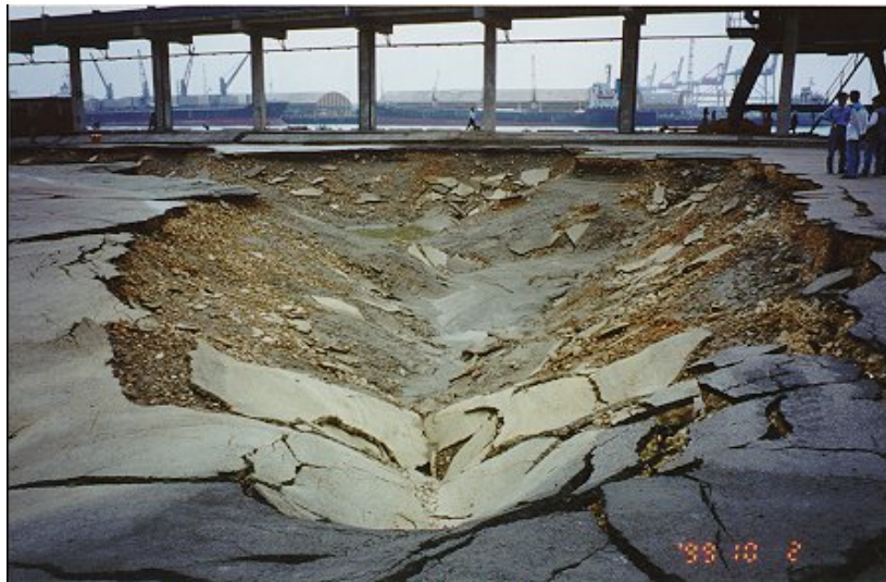
圖 1.2 臺中港 1 至 4A 碼頭內災損情況
