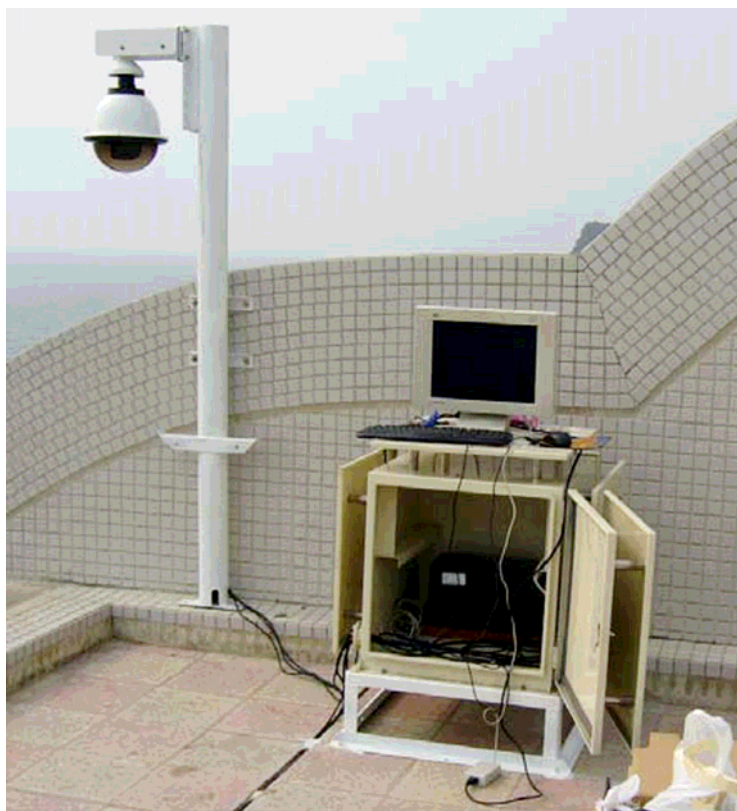
圖 3.1.1 影像儀器設備(攝影機、防水罩與觀測站主機)
