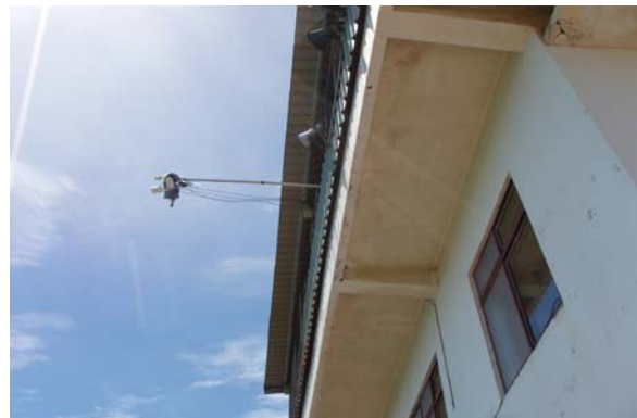
圖 4.10 安檢所儀器架設仰視圖
