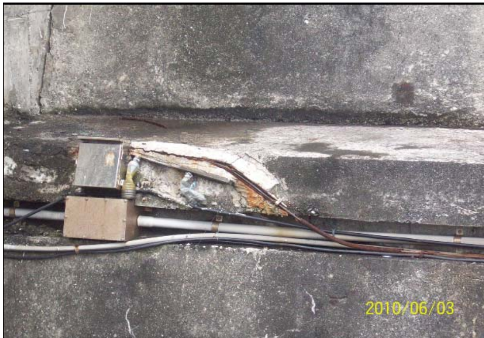
圖 3.27 花蓮港務局西防波堤鏽蝕 1 處
