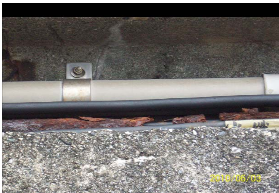
圖 3.28 花蓮港務局西防波堤鏽蝕 2 處
