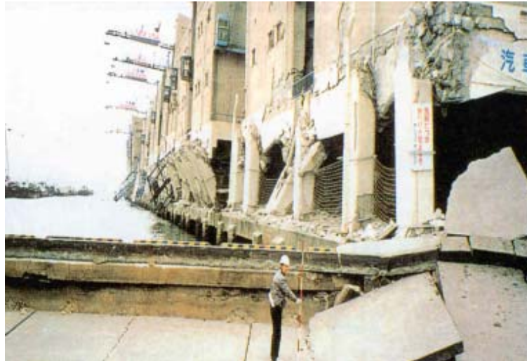
圖 2.4 日本阪神地震神戶港鉸樁式碼頭岸肩沈陷受損情形
