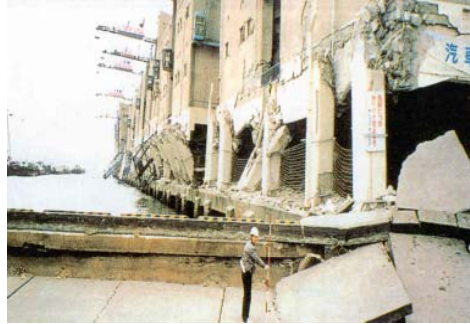
阪神地震神戶港版樁式碼頭岸肩沈陷受損
