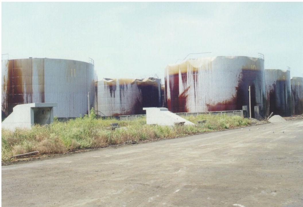
圖 3.6 921 臺中港儲槽災損情形
