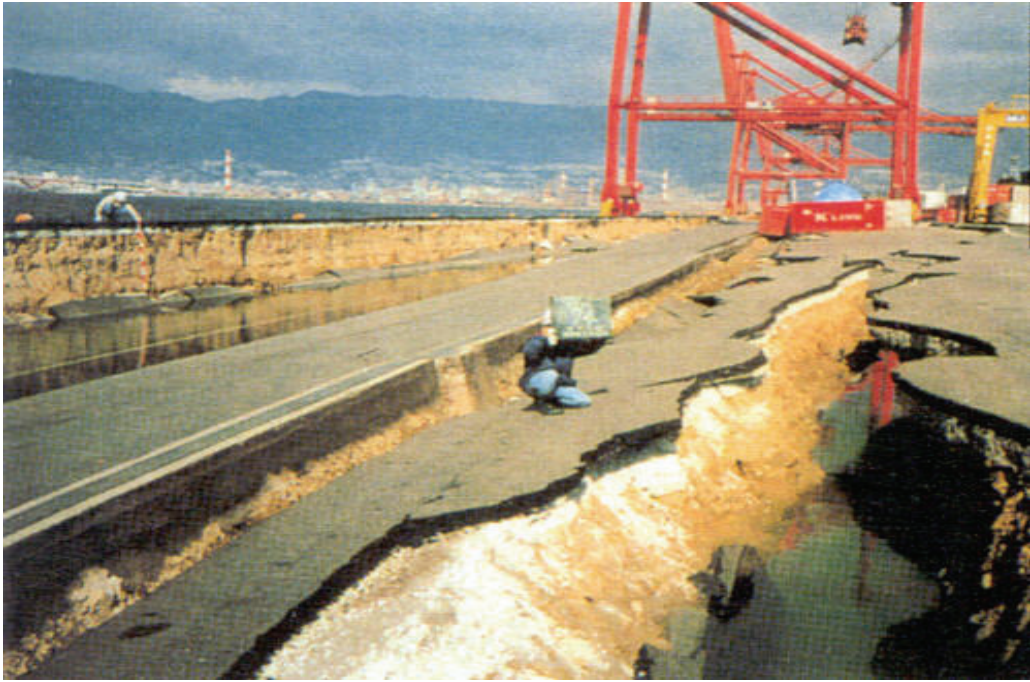
圖 3.9 日本阪神地震神戶港沉箱式碼頭後線沉陷災損情形
