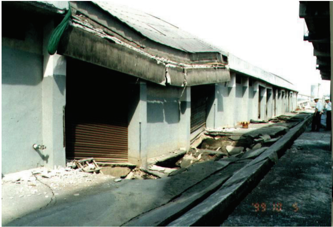
圖 3.5 921 臺中港倉儲設施災損情形
