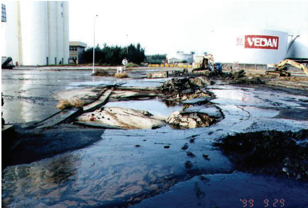
圖 3.7 921 臺中港糖蜜儲槽災損情形
