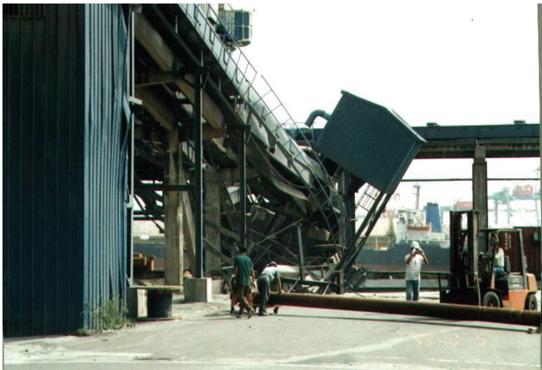
圖 3.4 921 臺中港裝卸設施災損情形
