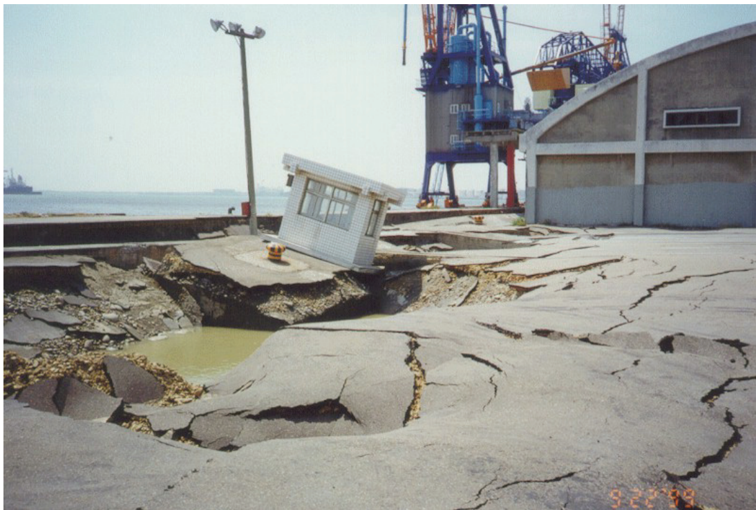
圖 3.3 #1~#4 沉箱式碼頭後線災損情形
