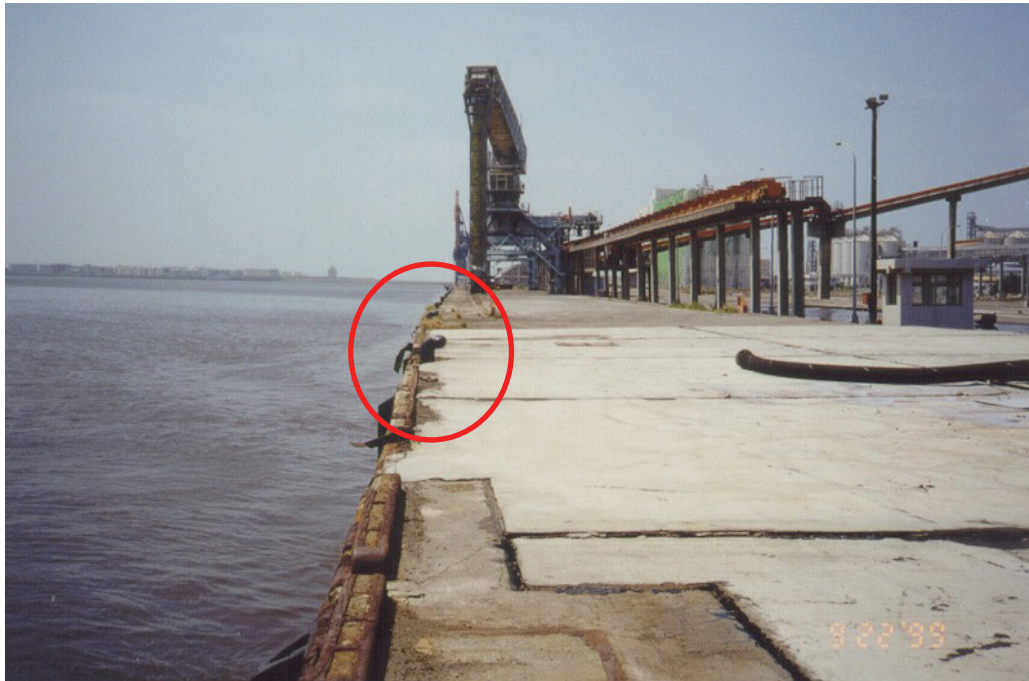
圖 3.1 #1~#4 沉箱式碼頭法線變位側視圖
