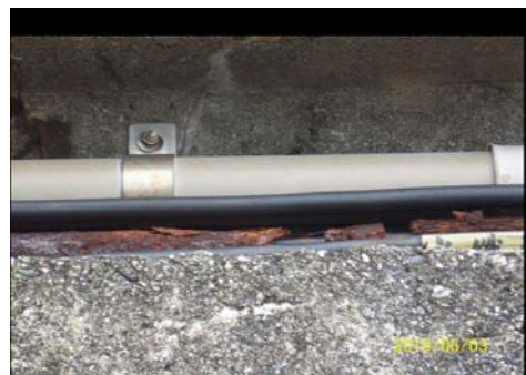
圖 3.28 西防波堤鏽蝕第 2 處
