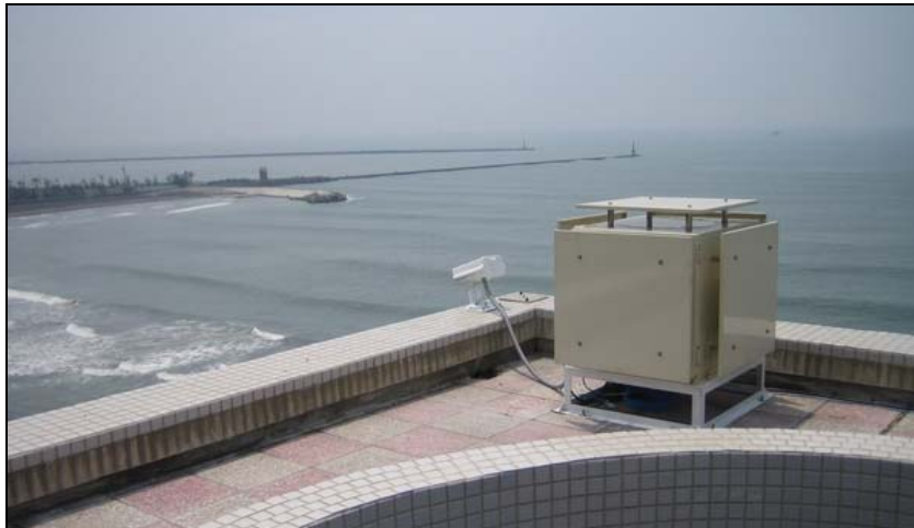
圖 4.1.1 影像儀器設備(攝影機、防水罩與觀測站主機機箱)
