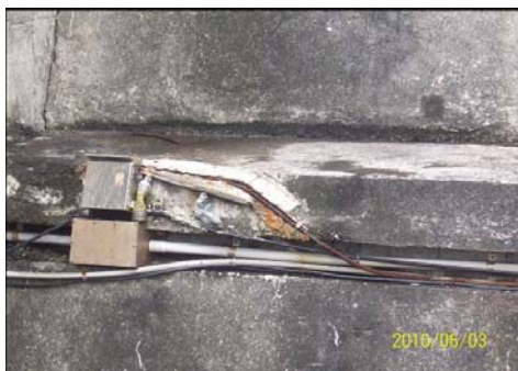
圖 3.27 西防波堤鏽蝕第 1 處
