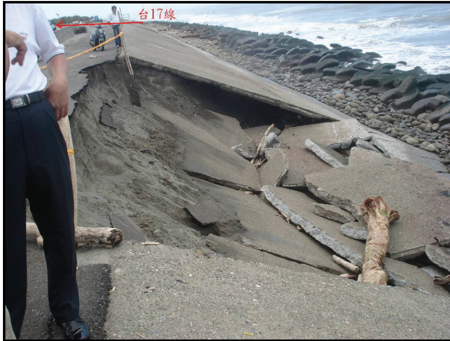
圖 5.3.9 臺 17 線臺南黃金海岸段邊坡護岸破壞情形
