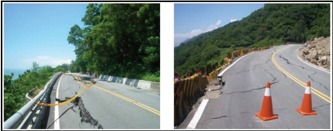
圖 5.3.6 臺 9 線 410K+650(左)及 411K+150 路面塌陷災害
