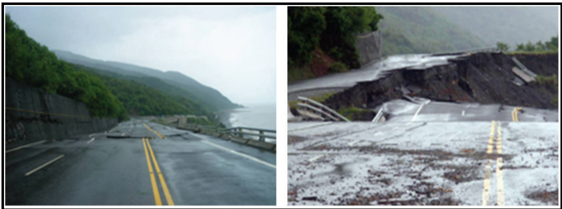
圖 5.3.7 臺 9 線 429K+800~430K 路面塌陷災害
