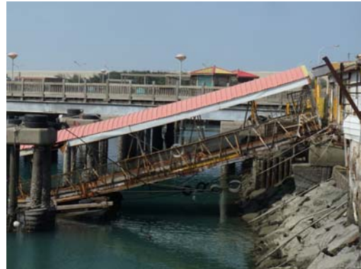
鋼構造物腐蝕情形
