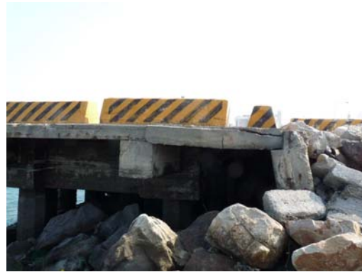
修船廠旁碼頭面版損壞情形
