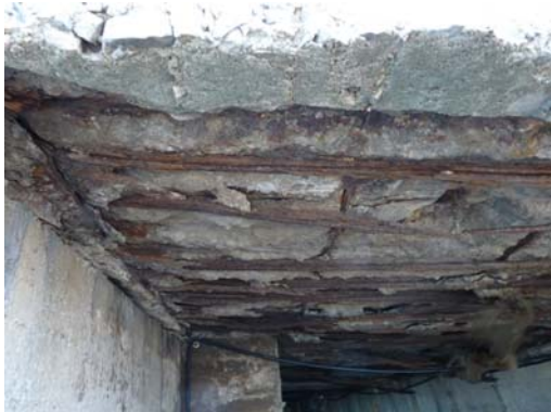
修船廠旁碼頭面版腐蝕劣化情形
