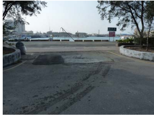
漁 (二) 路面沉陷情形 2
