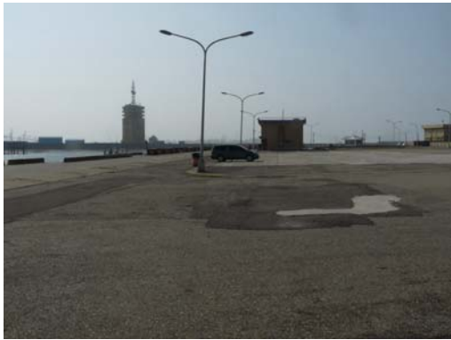
停 (三)、漁 (三) 路面沉陷情形
