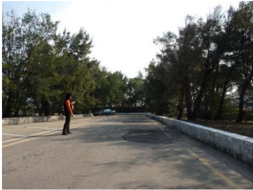
停 (二) 區域路面沉陷情形 1
