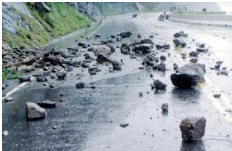
圖 4.29 巡檢人員發現現場土石崩落道路不安全
