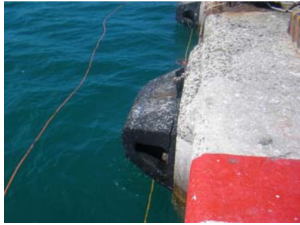
部份岸壁護舷材現況
