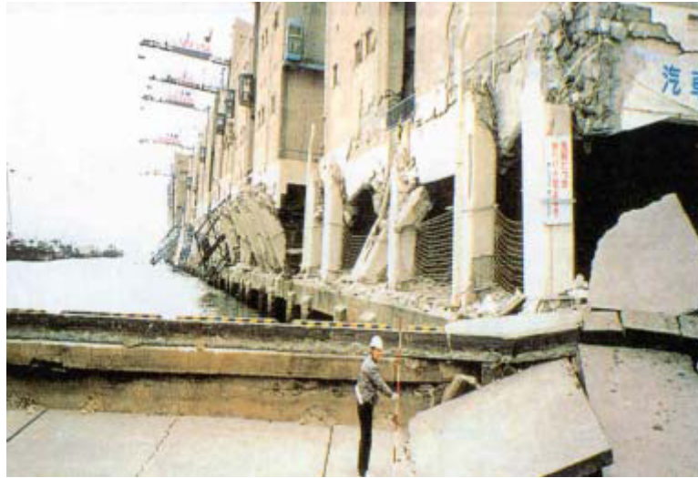
圖 2.3 日本阪神地震神戶港板樁式碼頭岸肩沈陷受損情形 (港灣技術研究中心, 1999)
