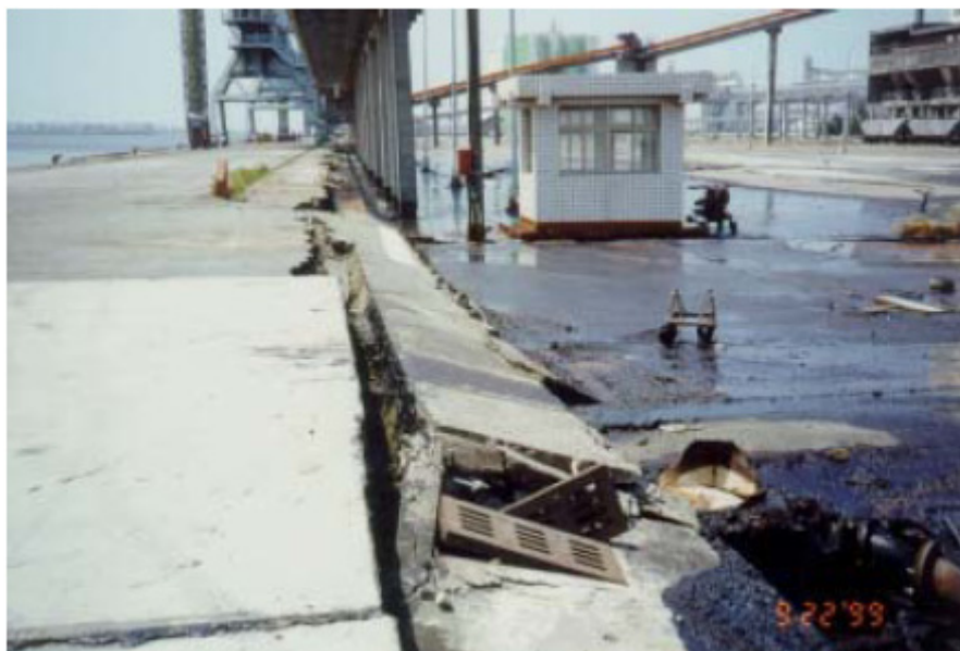
圖 2.2 臺中港#1~4 沈箱式碼頭於 921 震後碼頭岸肩與後線高程差側視圖 (港灣技術研究中心, 1999)
