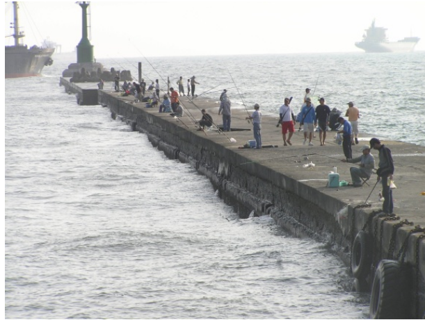
圖 4.6 沉箱防波堤內側海生較多
