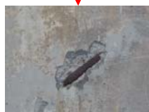
鋼筋腐蝕外露
