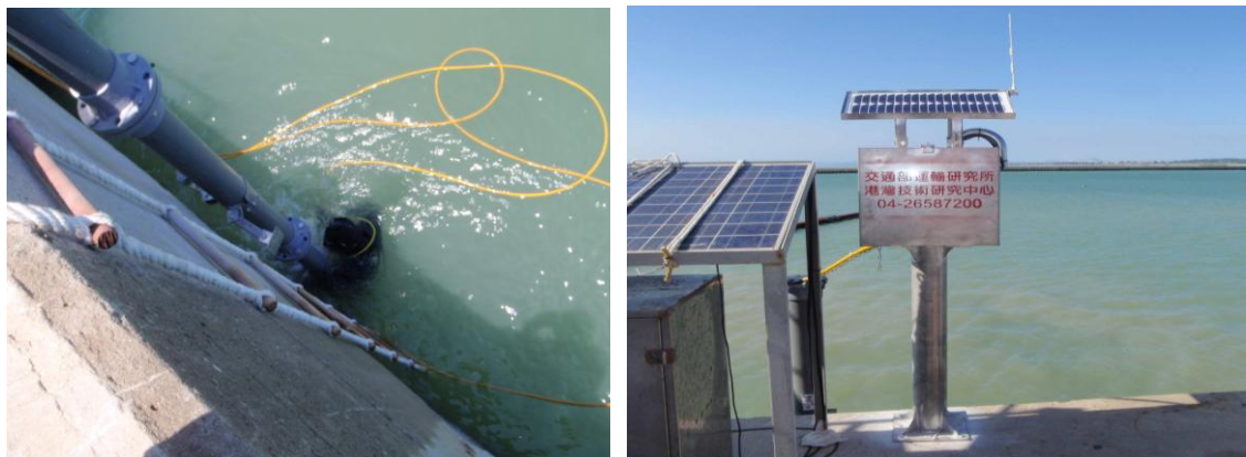
圖 2.8 H310 壓力式潮位儀即時 GPRS 傳輸監測系統
