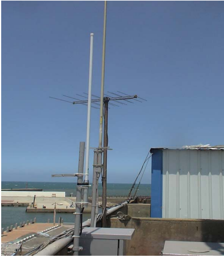
圖 6.3 苗栗外埔接收站 AIS 天線安裝
