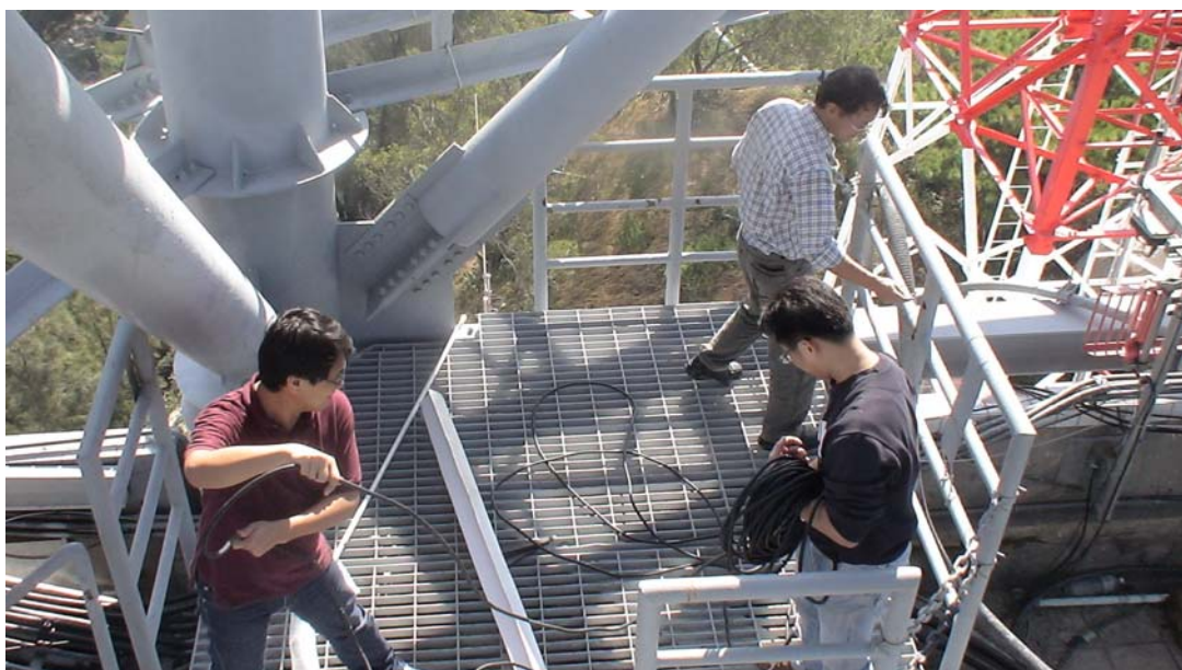
圖 6.9 金門太武山接收站 AIS 天線與主機配線
