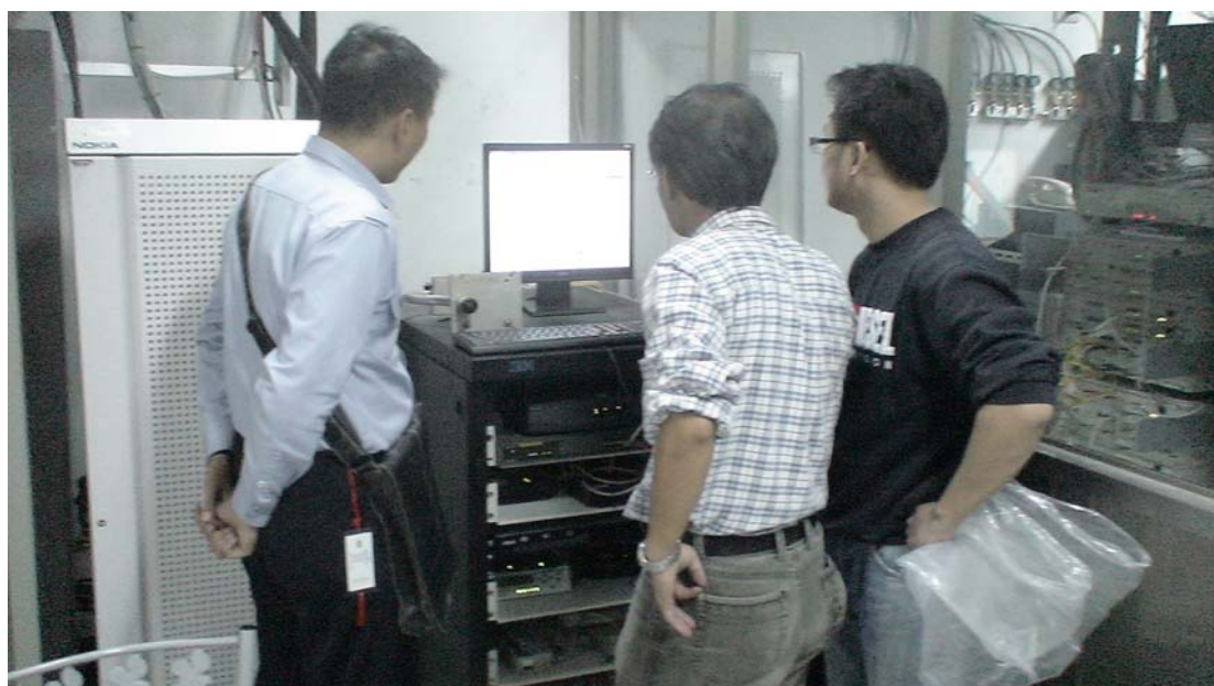
圖 6.10 金門太武山接收站 AIS 設備裝設及系統連線測試
