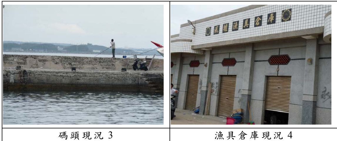
圖 3.70 風櫃東漁港現況情形（100.6.23）
