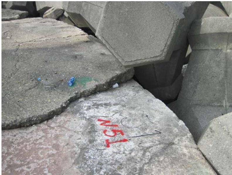
圖 4.6c 第二港口北防波堤#51 沉箱堤面破損情形
