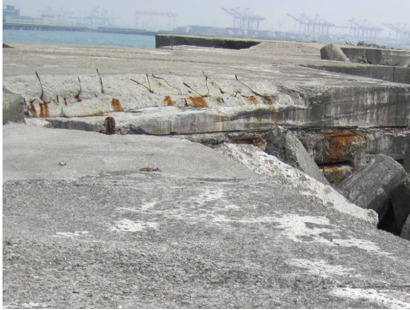
圖 4.7d 第二港口南防波堤#62 沉箱堤面破損情形
