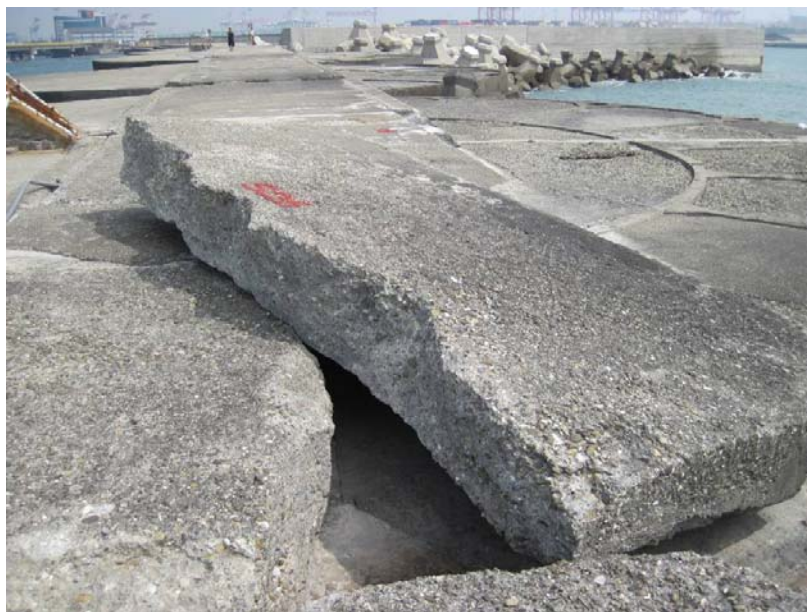
圖 4.7a 第二港口南防波堤#26 沉箱堤面破損情形
