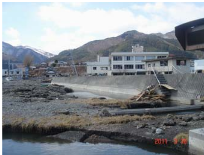
圖 5.9 碼頭與岸壁遭海嘯破壞後受損情形(左：相馬港，右：茨城港)
