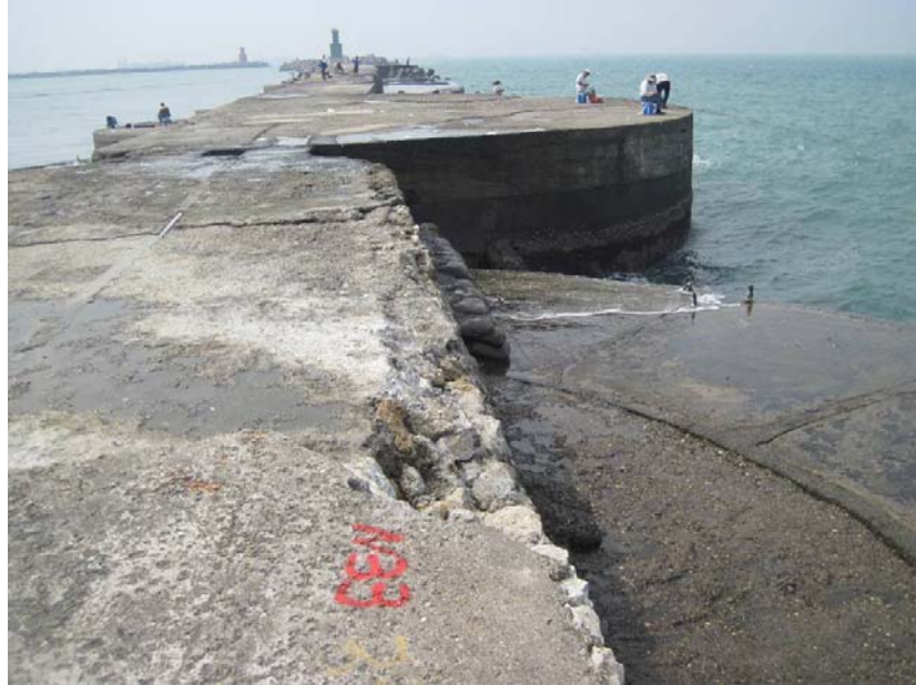
圖 4.6a 第二港口北防波堤#33 沉箱堤面破損情形
