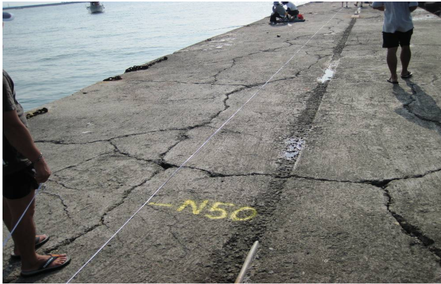
圖 4.4 第一港口北防波堤 0k+050 堤面裂痕情形
