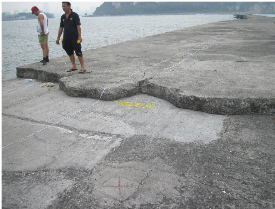
圖 4.5 第一港口南防波堤 0k+472 堤面落差情形
