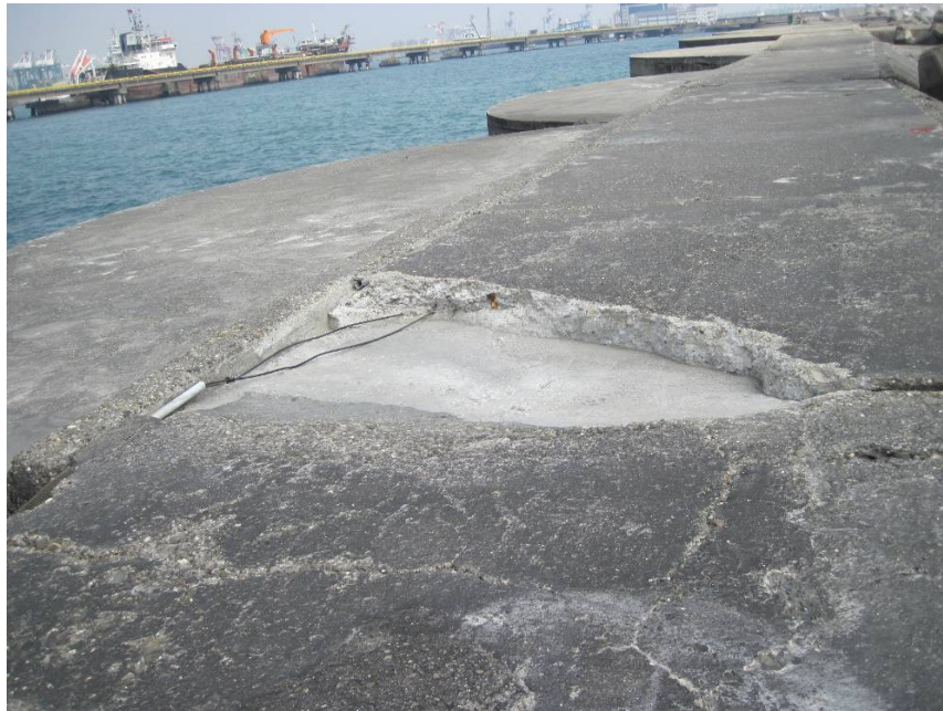
圖 4.7b 第二港口南防波堤#32 沉箱堤面破損情形
