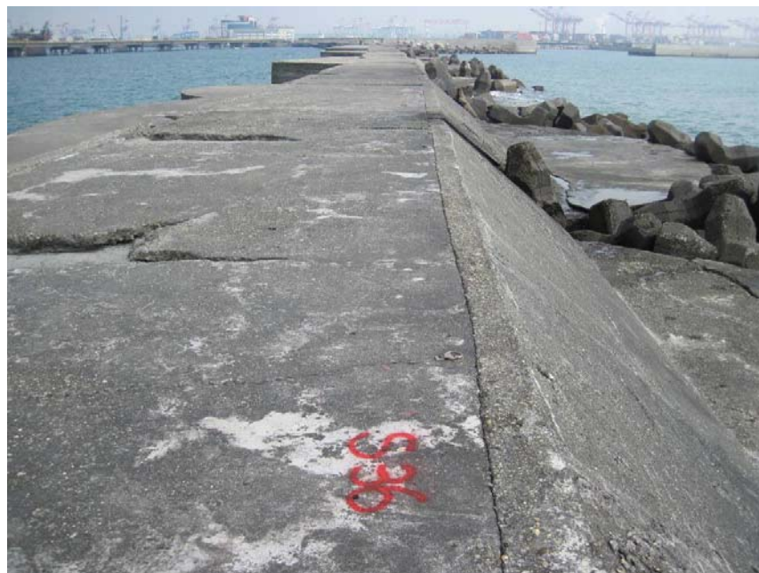
圖 4.7c 第二港口南防波堤#36 沉箱堤面破損情形
