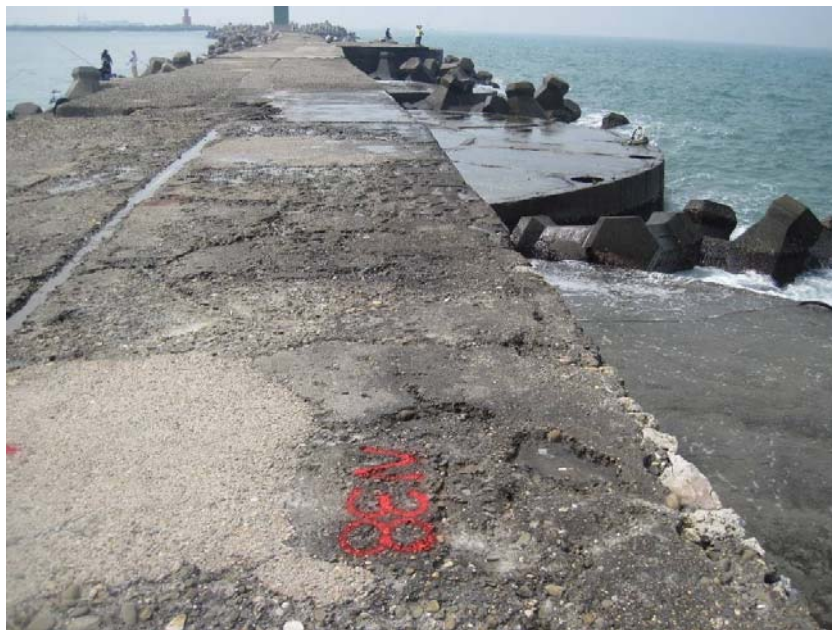
圖 4.6b 第二港口北防波堤#38 沉箱堤面破損情形
