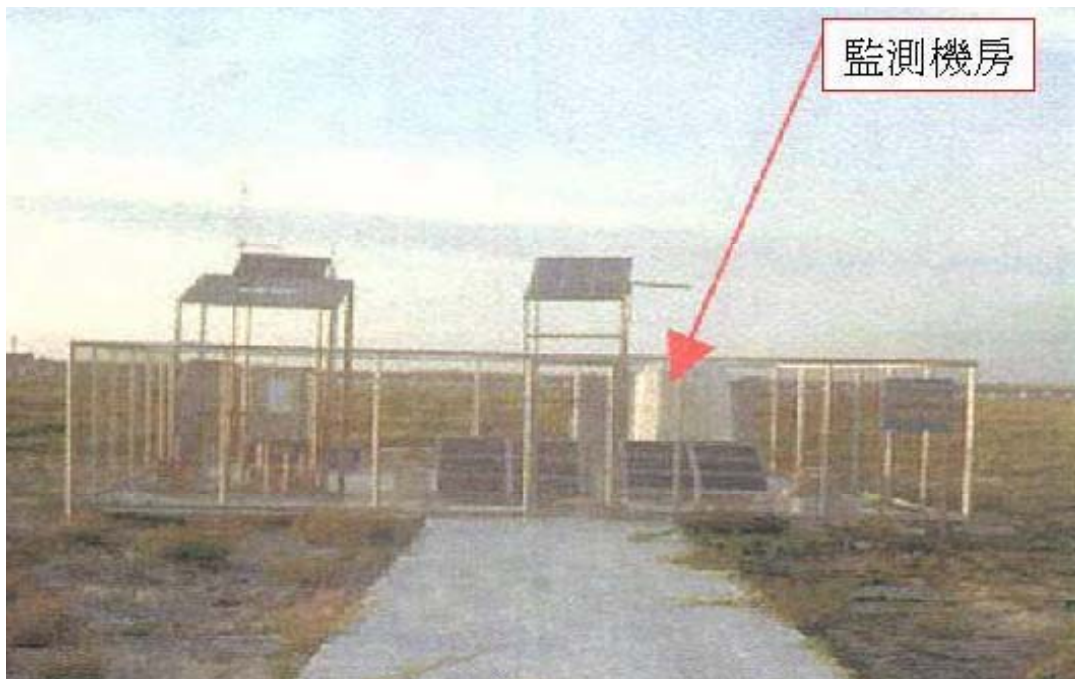
圖 2-9 布袋港區地震分層監測站設置完成外貌狀況
