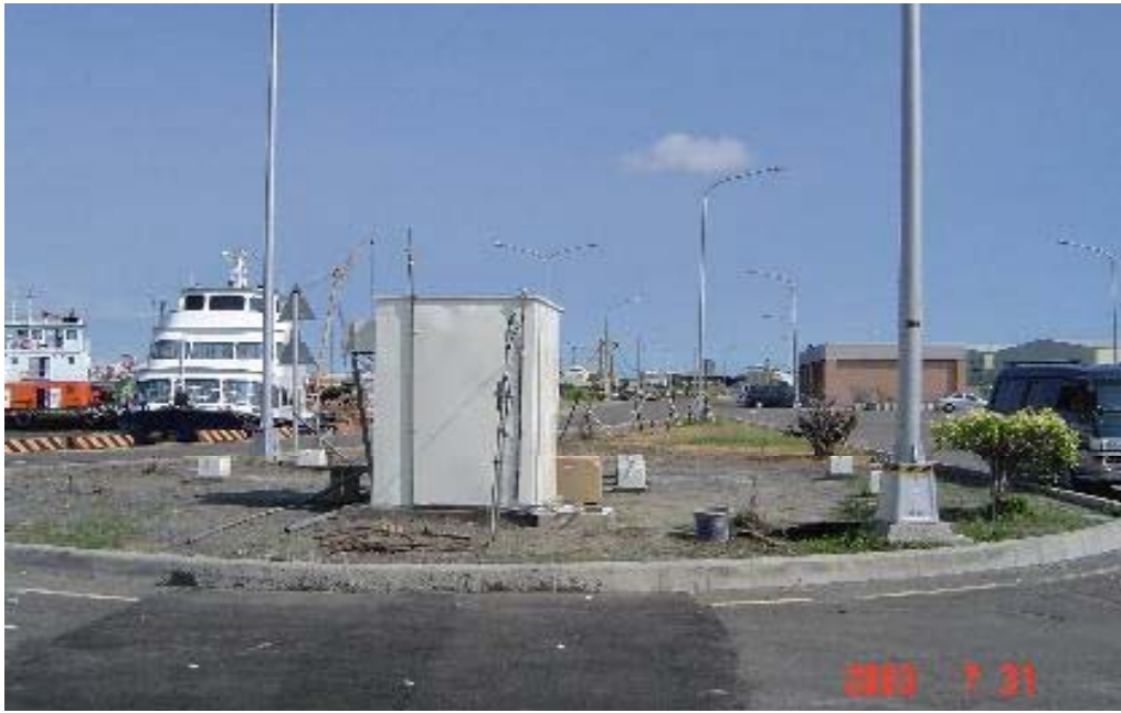
圖 2-13 高雄區地震分層監測站設置完成外貌狀況
