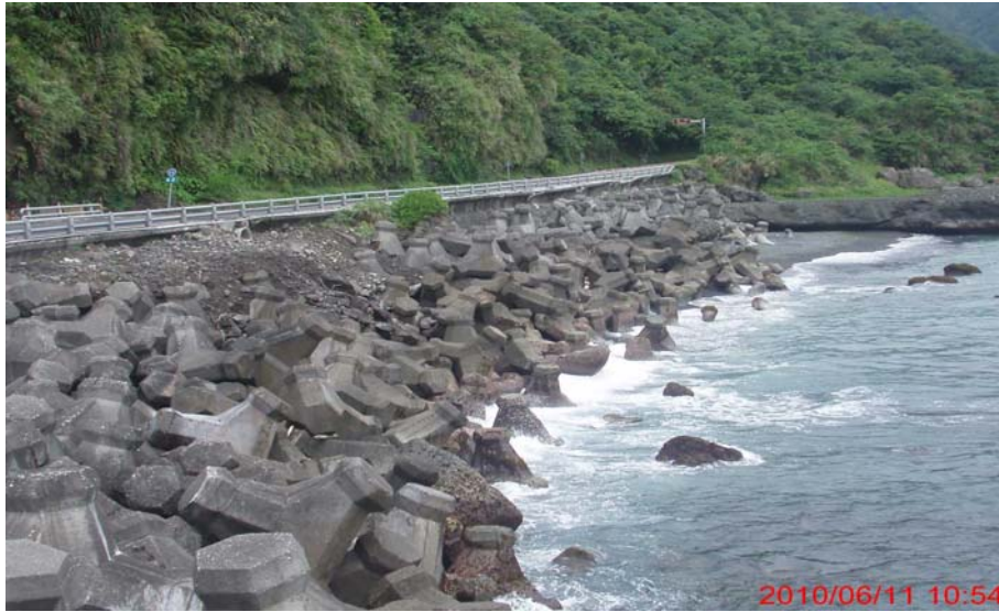
圖 5.3.2 海岸公路前消波塊保護公路情形
