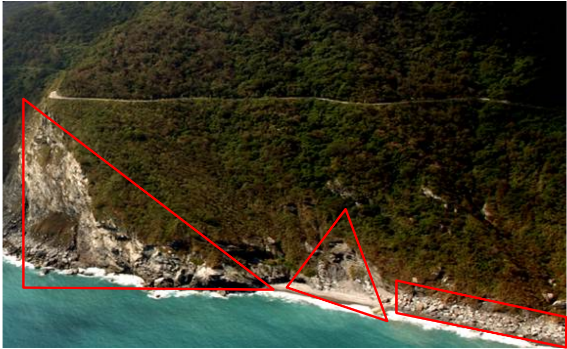
圖 5.3.8 臺 9 線蘇花公路邊坡岩性不佳之崩落情形
