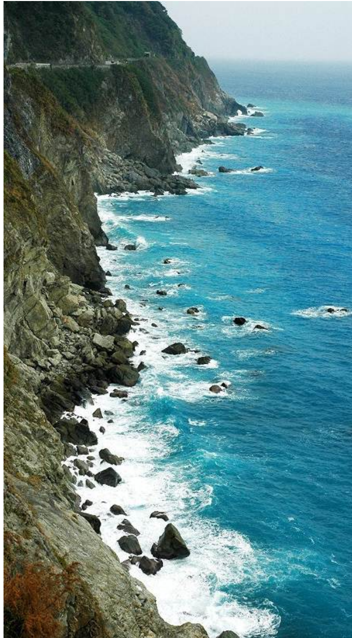
圖 5.3.7 舊臺 9 線公路邊坡岩性不佳之崩落情形
