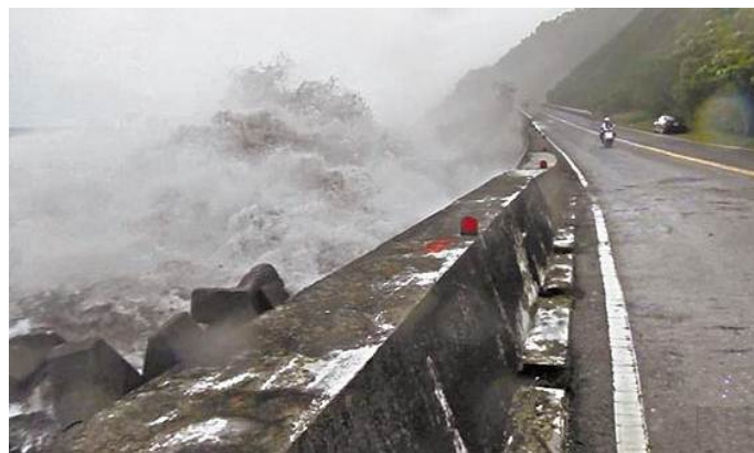
圖 5.3.14 海岸公路護岸消能不足造成大浪越波
