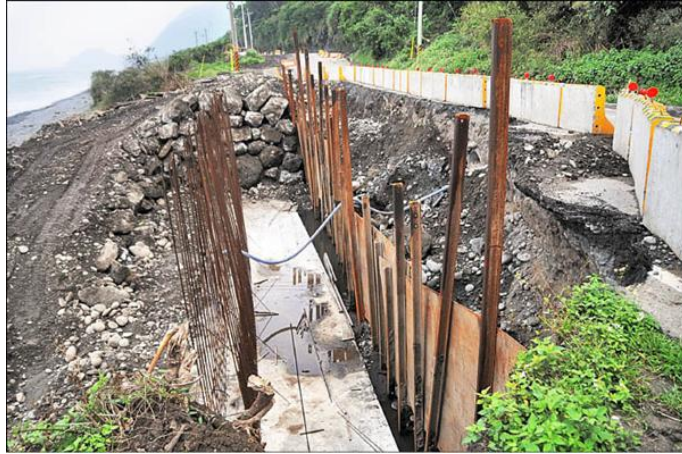
圖 5.3.15 海岸公路邊坡護岸被波浪淘空崩塌(取自自由時報,2009)
