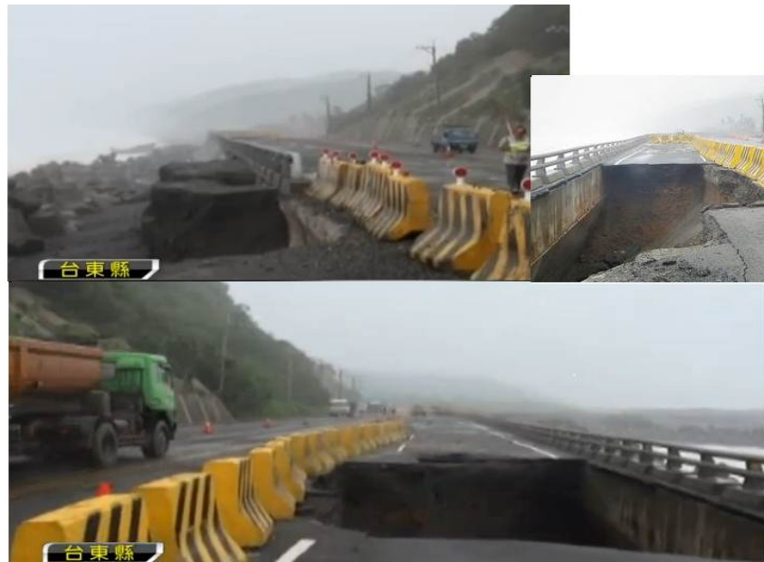
圖 5.3.5 臺 9 線南迴段道路遭大浪破壞情形(聯合新聞網)
