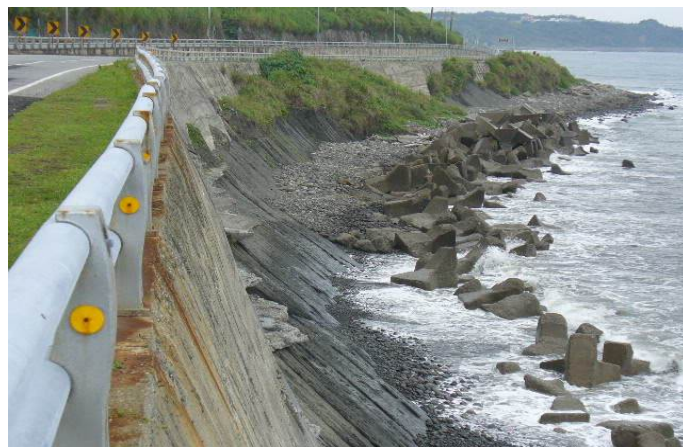
圖 5.3.13 海岸公路前消波塊及護岸混凝土剝落毀損
