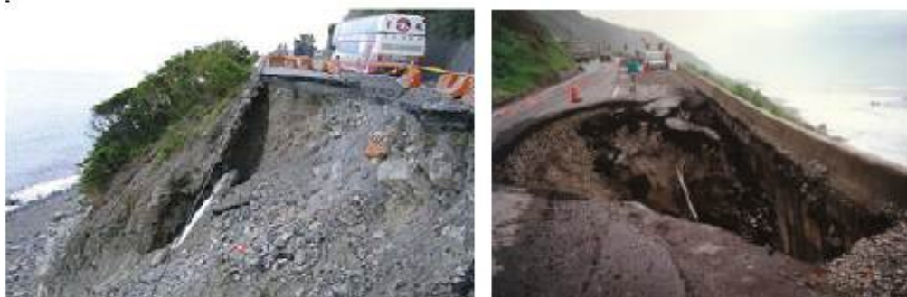
圖 5.3.10 坡面滑動及下陷流失造成破壞情形
