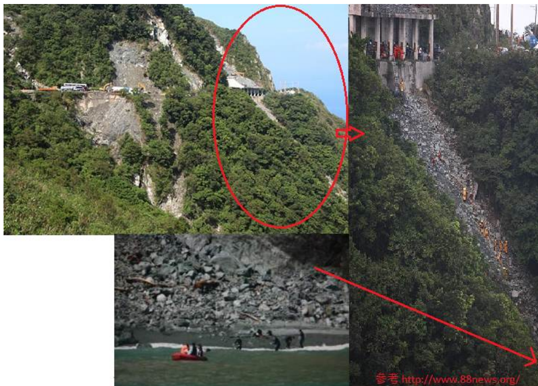
圖 5.3.11 梅姬颱風侵襲造成邊坡崩塌事件
