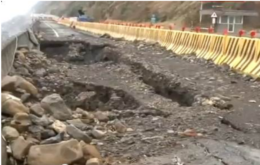
圖 5.3.3 南迴公路路基波浪沖蝕致路面塌陷毀損(民視畫面)
