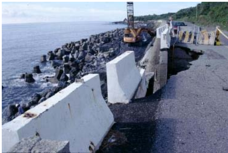
圖 5.3.1 海岸公路嘉平段路面塌陷情形
