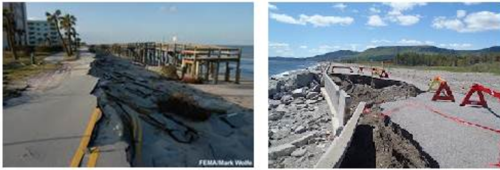
圖 5.1.2 海岸公路破壞情形
