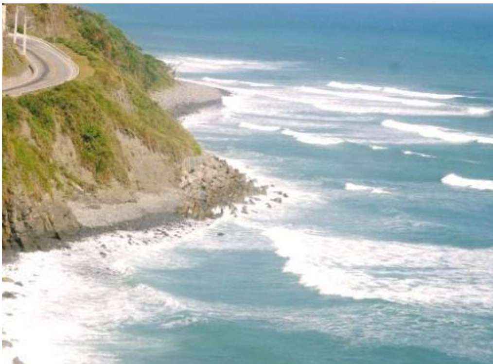
圖 5.3.9 臺 11 線公路邊坡坡面滑動及土石崩落情形
