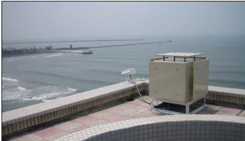
圖 3.1.1 影像儀器設備(攝影機、防水罩與觀測站主機機箱)
