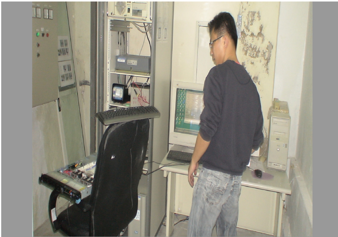
圖 8.21 澎湖吉貝嶼接收站設備裝設及連線測試(西元 2012 年 11 月)
