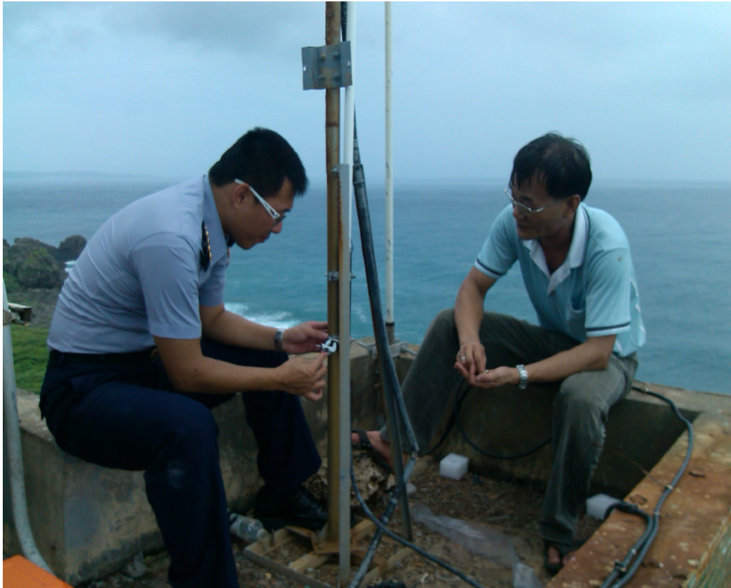
圖 8.16 屏東貓鼻頭 AIS 天線與主機配線(西元 2012 年 8 月)
