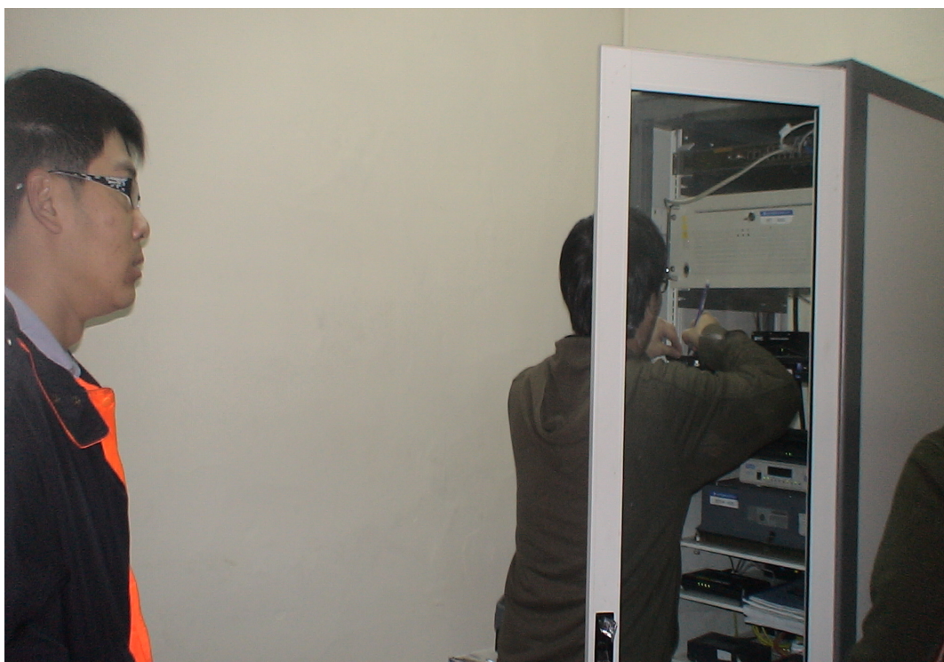
圖 8.12 馬祖北竿 AIS 天線與主機配線(西元 2012 年 3 月)
