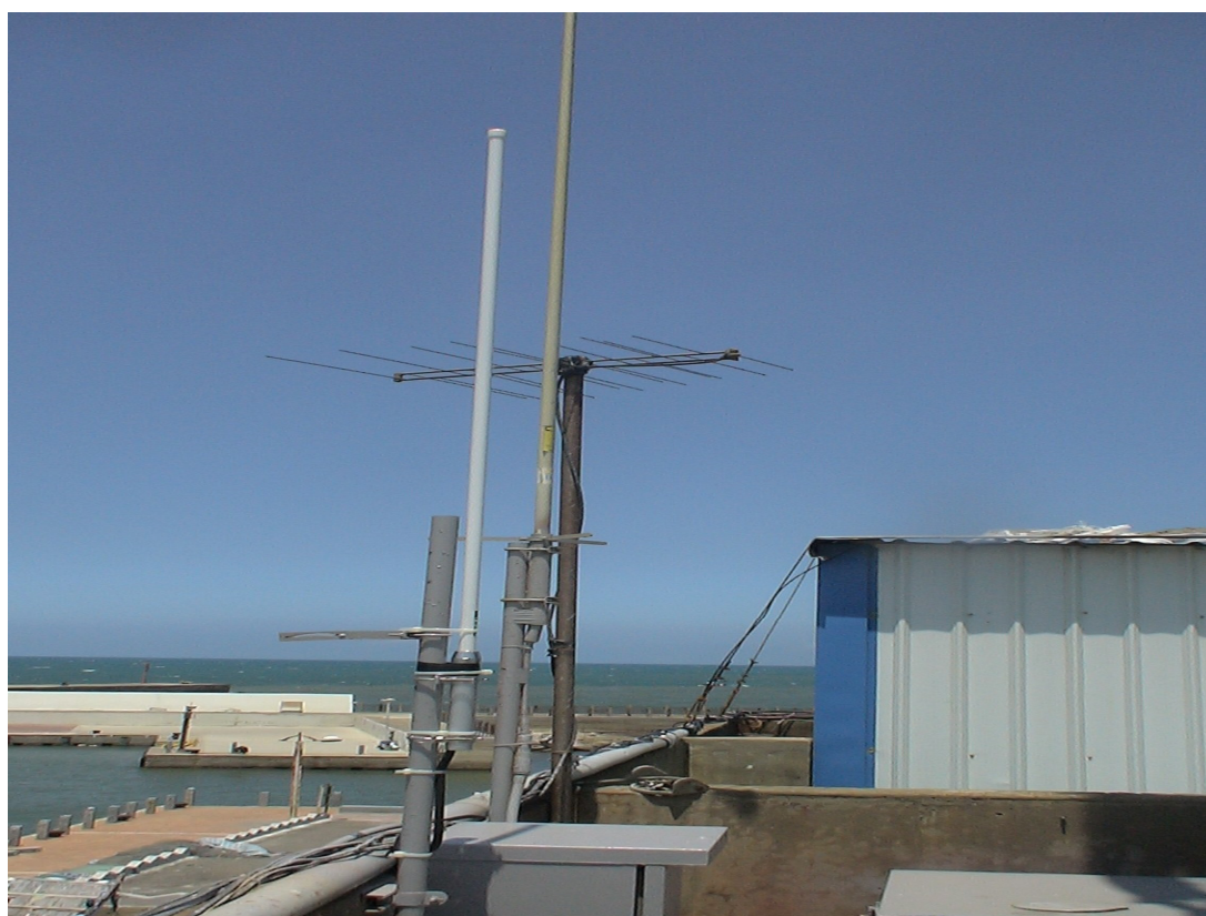
圖 8.3 苗栗外埔接收站 AIS 天線安裝(西元 2011 年 8 月)
