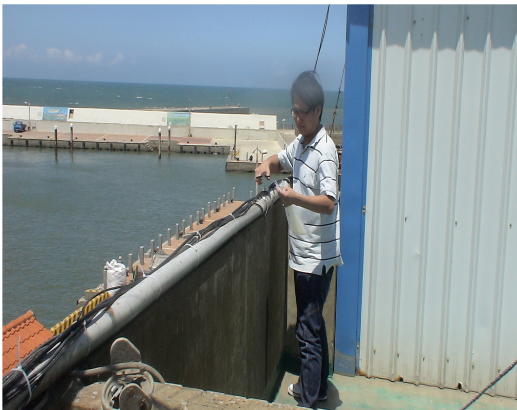
圖 8.4 苗栗外埔接收站 AIS 天線與主機配線(西元 2011 年 8 月)
