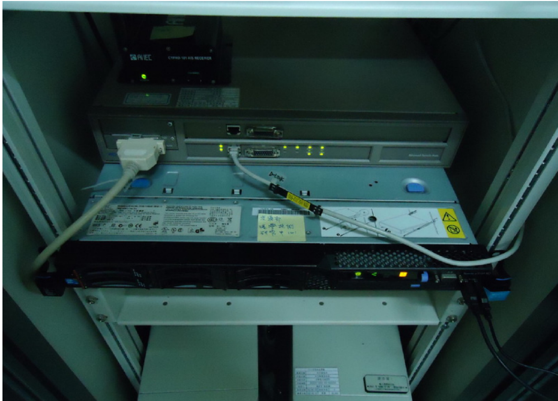
圖 8.20 澎湖吉貝嶼 AIS 天線與主機配線(西元 2012 年 11 月)
