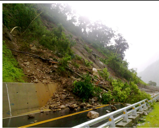
圖 7.42 台 24 線 31K+500 於莫拉 克期間道路阻斷情形
