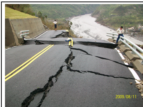
圖 7.43 台 24 線 31K+500 於莫拉克 颱風期間道路阻斷情形
