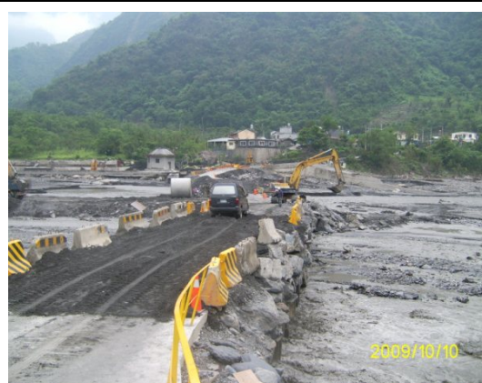
圖 7.44 台 24 線 32K+890 於芭瑪 颱風期間道路阻斷情形
