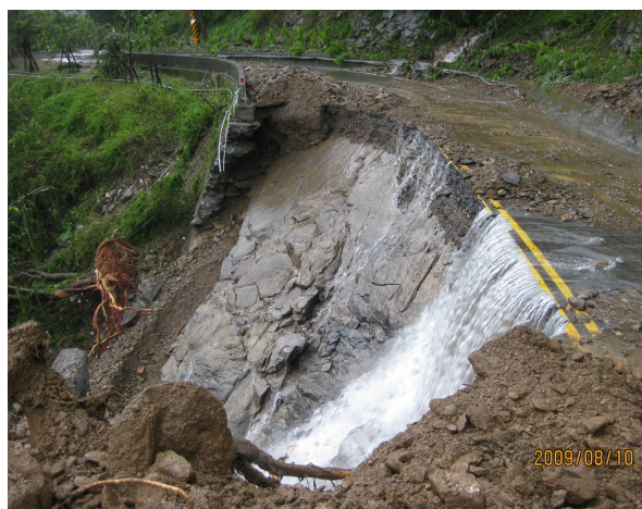
圖 7.37 台 24 線 26K+000 於莫拉克 颱風期間道路阻斷情形
