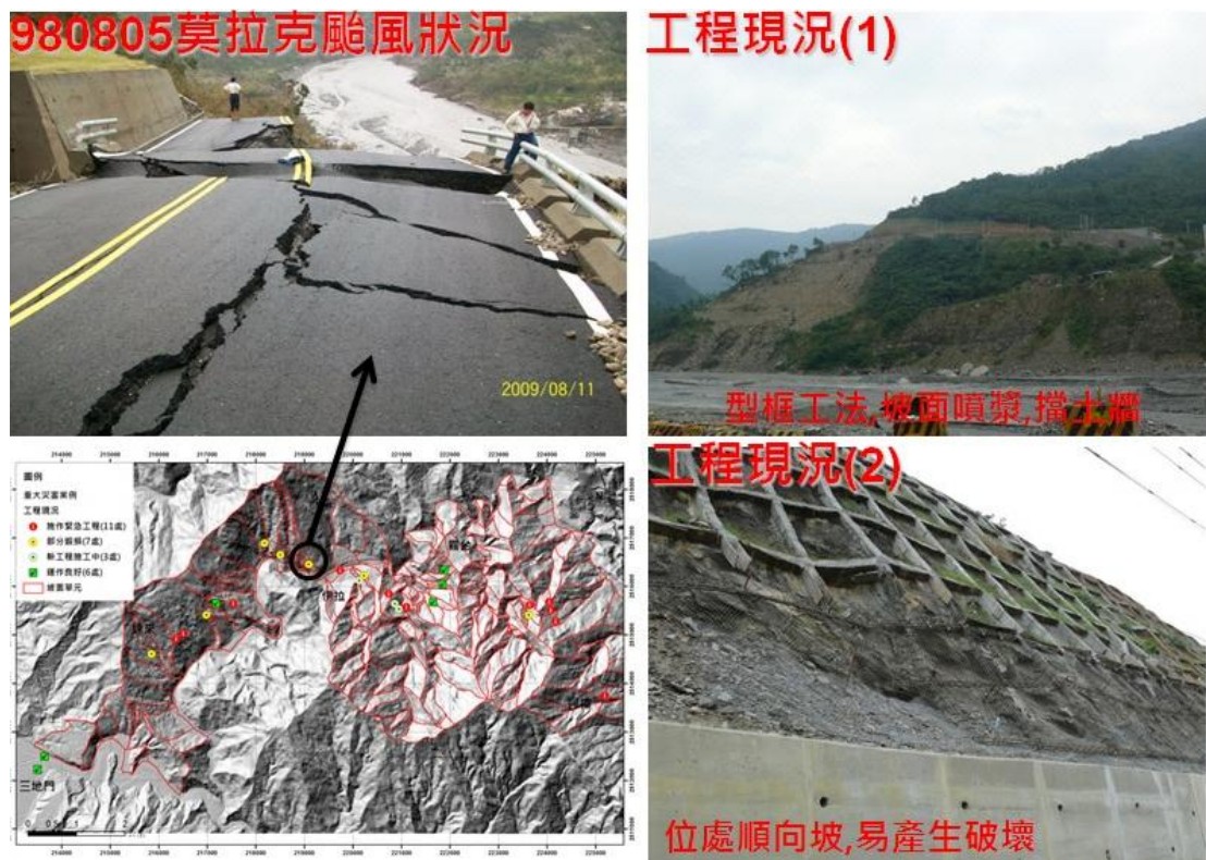
圖 7.80 樁號 31K+500 岩體滑動災害狀況與復建工程現況圖
