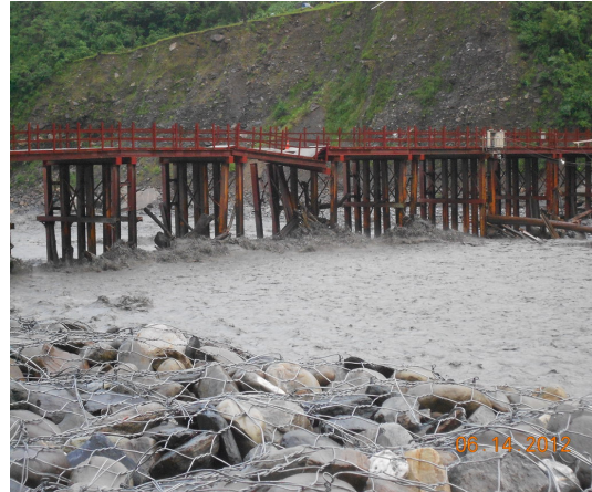
圖 7.56 台 24 線 32K+890 於 0609 豪雨事件便道毀損情形
