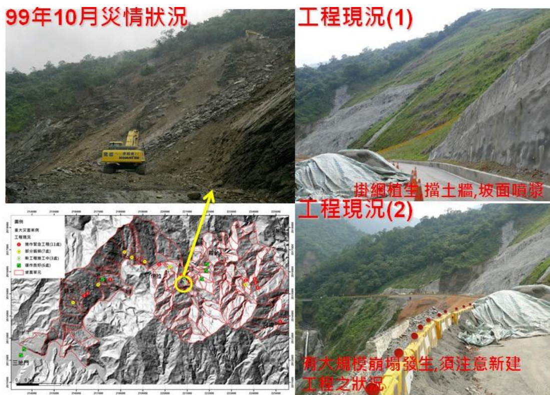
圖 7.82 樁號 35K+400 岩體滑動災害狀況與復建工程現況圖
