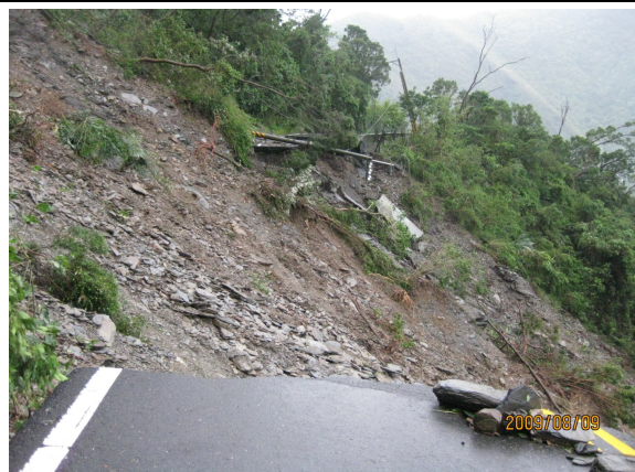
圖 7.39 台 24 線 28K+300 於莫拉克 颱風期間道路阻斷情形
