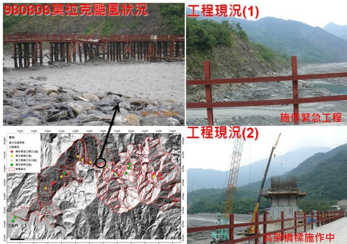
圖 7.81 樁號 32K+890 岩體滑動災害狀況與復建工程現況圖
