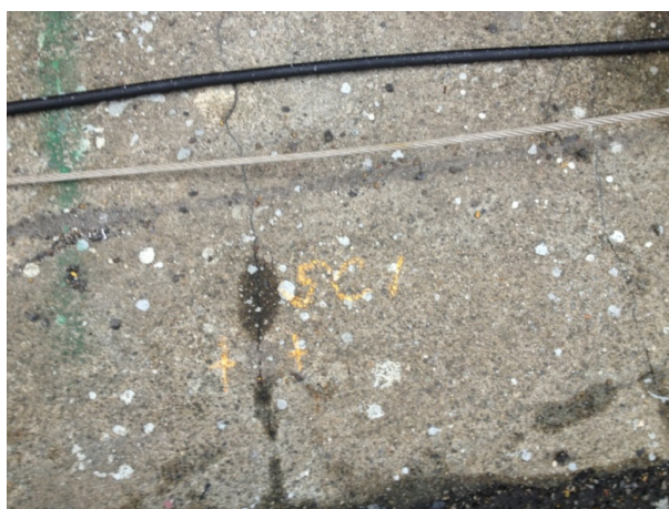
圖 3.138 標的裂縫之現況（編號 SC1）
