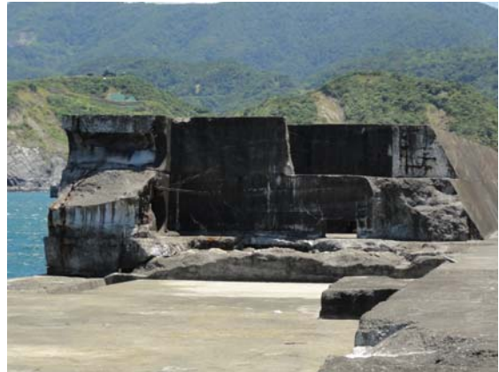
圖 4.10b #24 沉箱隔艙破壞情形
