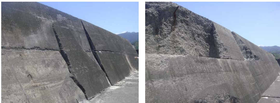
圖 4.13 胸牆後側混凝土剝落現況
