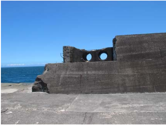
圖 4.10a #24 沉箱後側胸牆破壞情形
