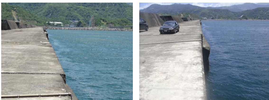
圖 4.14 沉箱發生錯位現況
