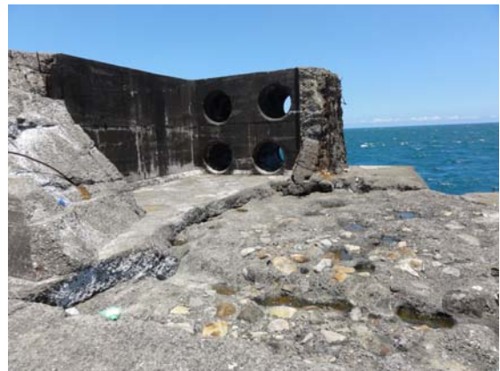
圖 4.12 #27 沉箱後側胸牆破壞情形
