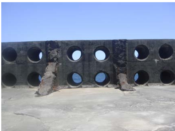
圖 4.9a #31 沉箱消波艙破壞情況
