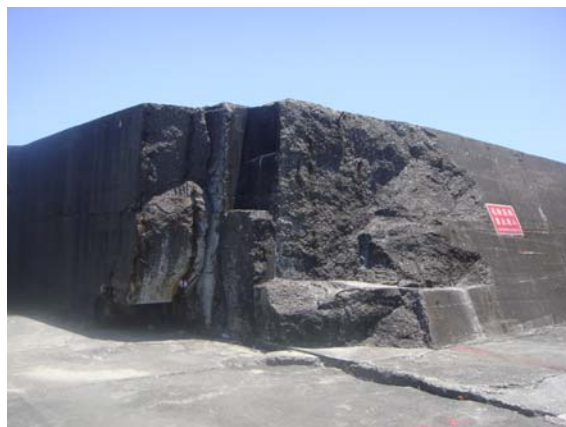
圖 4.9b #31 沉箱後側胸牆破壞情形
