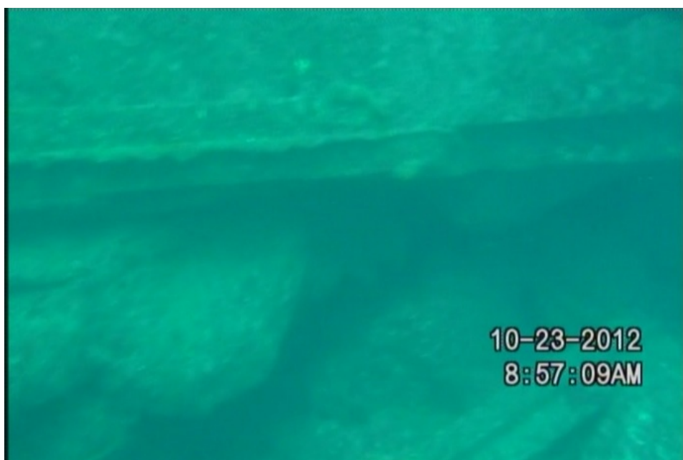
圖 4.5a 蘇澳港南防波堤#19 沉箱底部掏空情況
