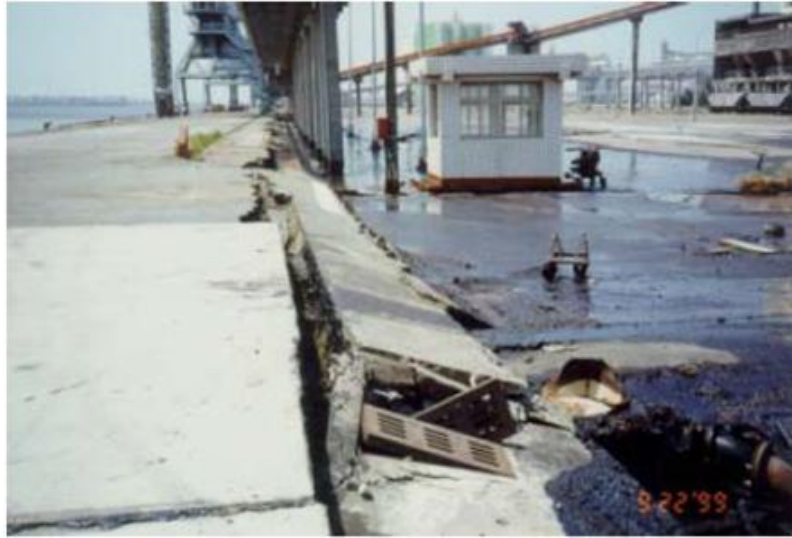
圖 2.3 臺中港#1~4 沉箱式碼頭於 921 震後碼頭岸肩與後線高程差側視圖 (Chen and Huang, 2000)
