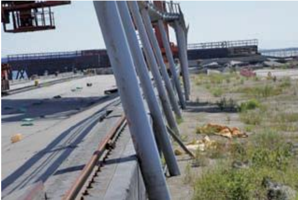
圖 1.3 東日本大地震(後側地盤差異沉陷)
