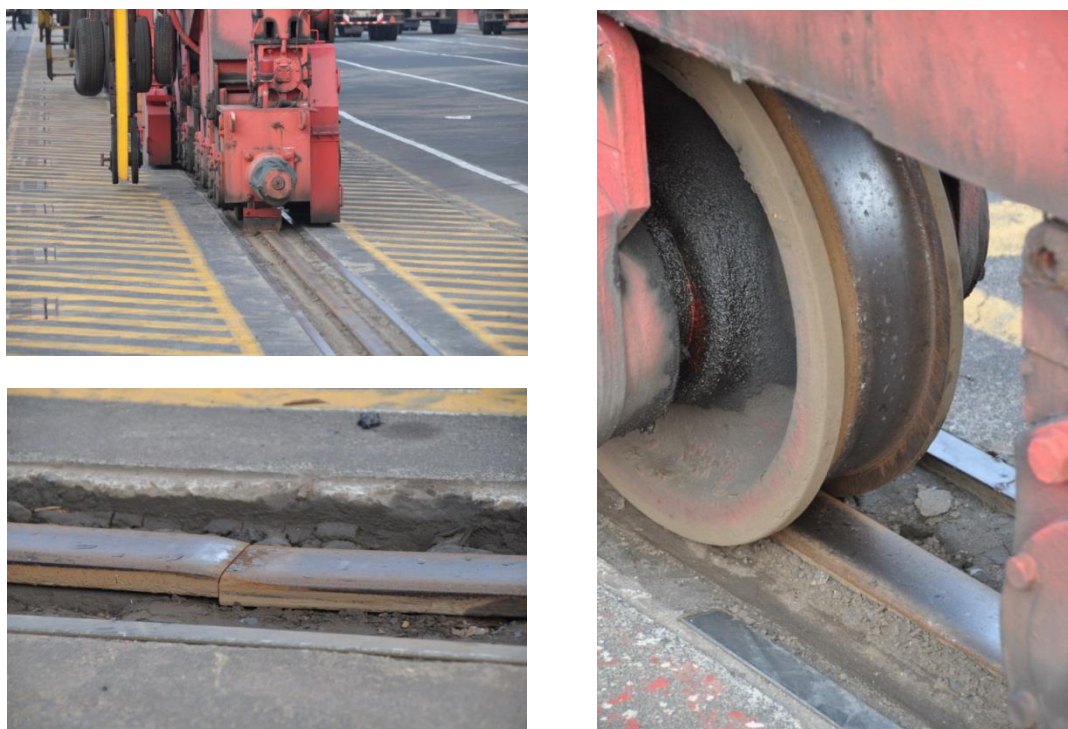
圖 6.9 起重機軌道損壞鋼軌接縫高差照片
