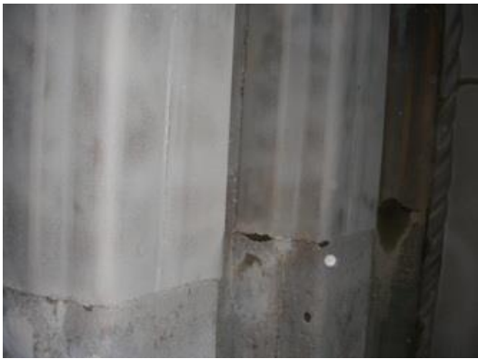
圖 7.6 典型鋼板樁碼頭構造局部破損穿孔現象
