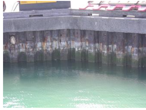
圖 7.5 典型鋼板樁碼頭構造銹損破壞現象
