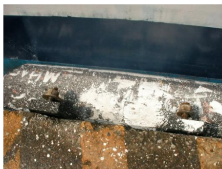
圖 8.35 基隆港東 2 號碼頭防舷材劣化異狀照片
