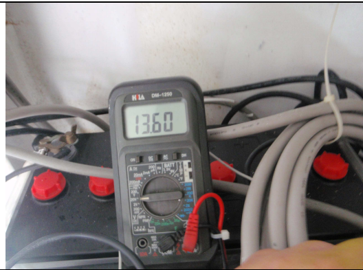
閃光燈電瓶電壓 13.6 伏特
