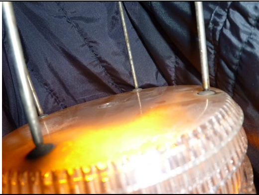
備用黃色大閃光燈電池正常
