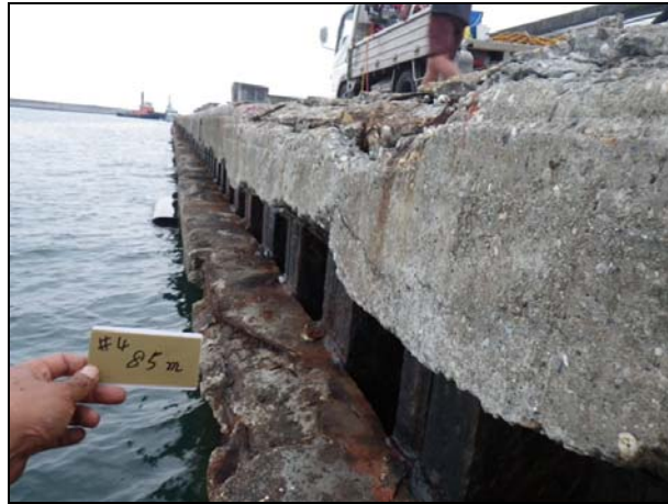
圖 4.3 岸肩混凝土剝落或鋼筋腐蝕外露情形(#4 ~ #5)
