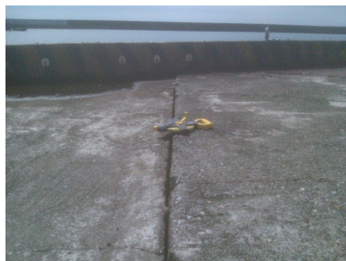
25 號碼頭路面現況情形 2
