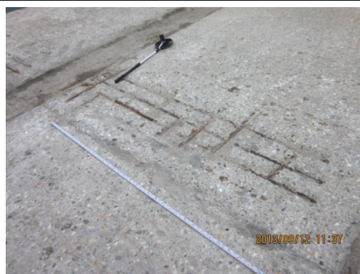
24 號碼頭岸肩路面現況情形
