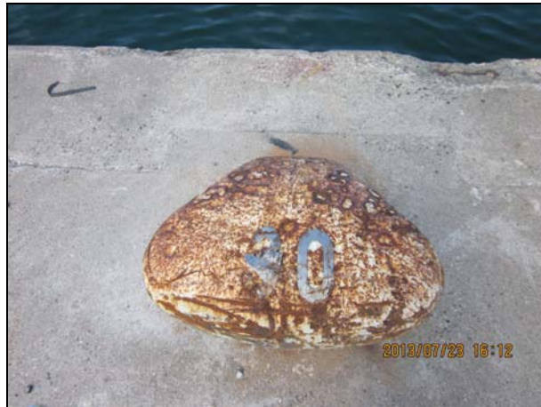
圖 4.5 繫船樁表面腐蝕情形
