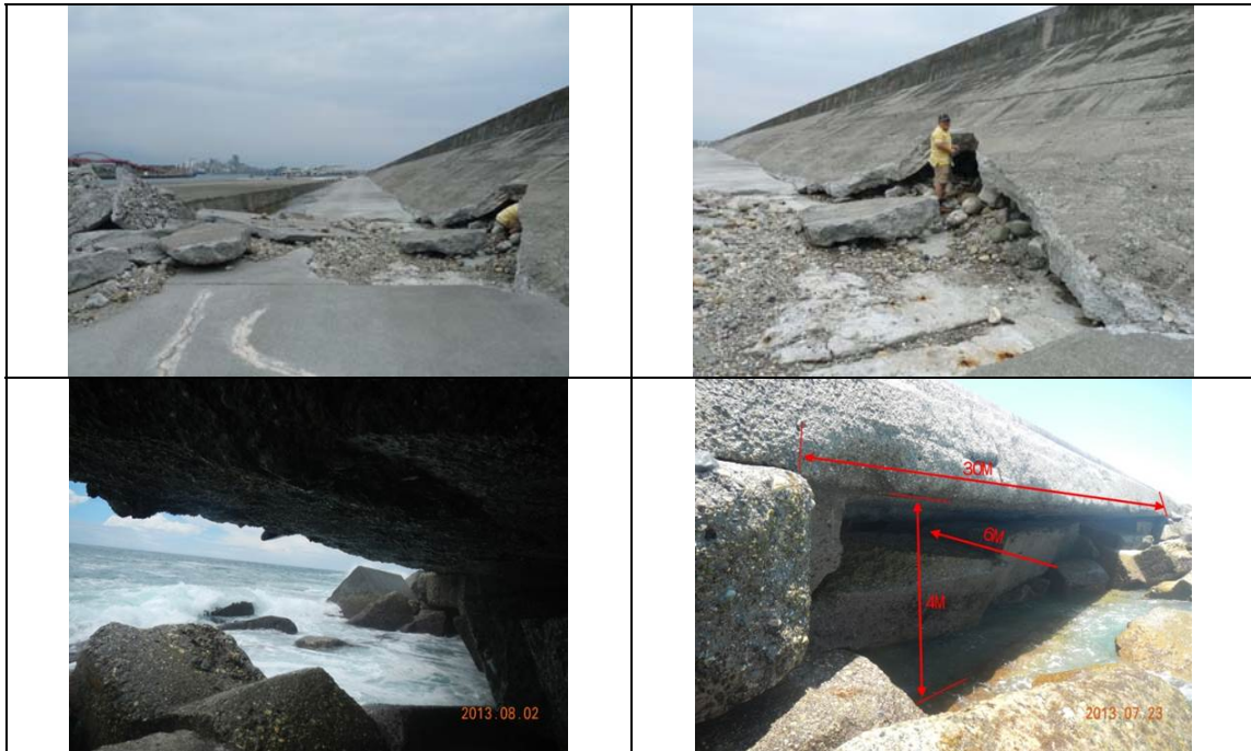
圖 4.7 舊東堤 0K+660m 處掏空情形
