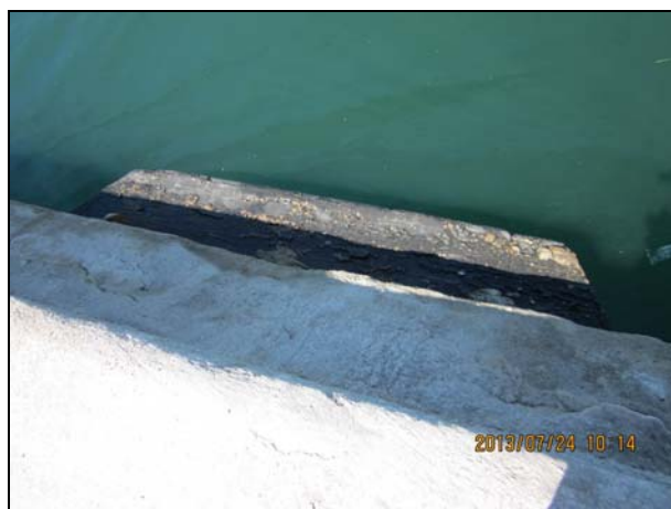
圖 4.4 護舷材破損、材質劣化情形
