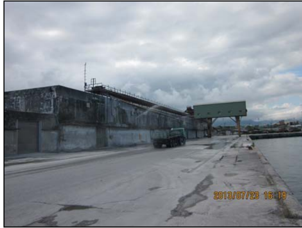
圖 4.2 碼頭面版龜裂、沈陷情形(#5 ~ #6)
