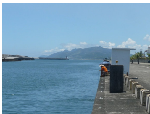
航道西側岸肩現況情形 2
