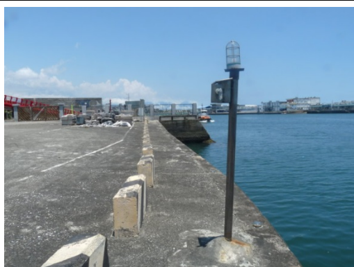
航道西側岸肩現況情形 1
