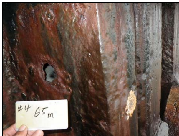
圖 4.6 飛沫帶鋼板樁表面腐蝕情形(#4 ~ #5)
