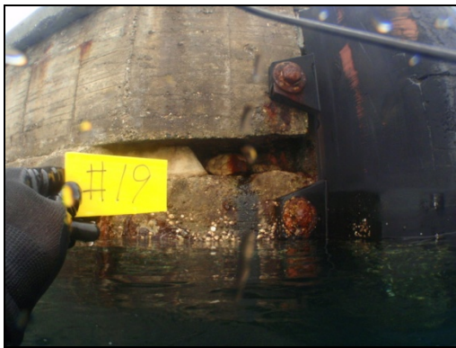
圖 4.15 混凝土接縫處劣損現況 (19 號碼頭)
