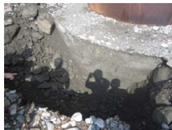
水壓計及鐵架遺失(2013年11月27日)
