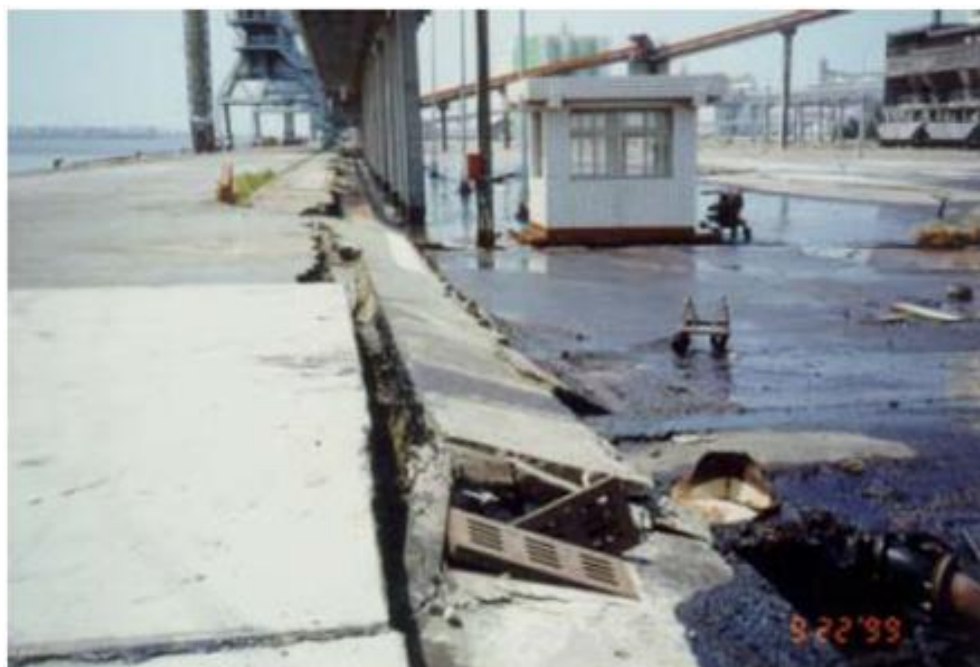
圖 2.5 臺中港#1~4 沉箱式碼頭於 921 震後碼頭岸肩與後線高程差側視圖 (Chen and Huang, 2000)
