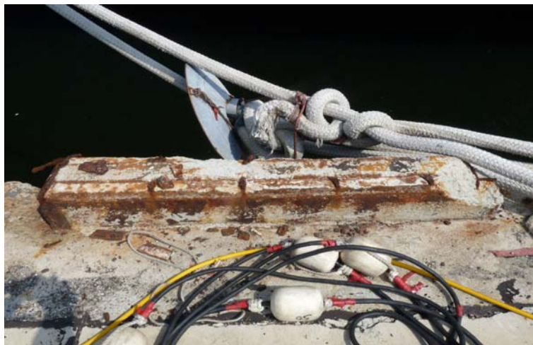
圖 3.28 安平港 4 號碼頭車擋鐵框生鏽情形
