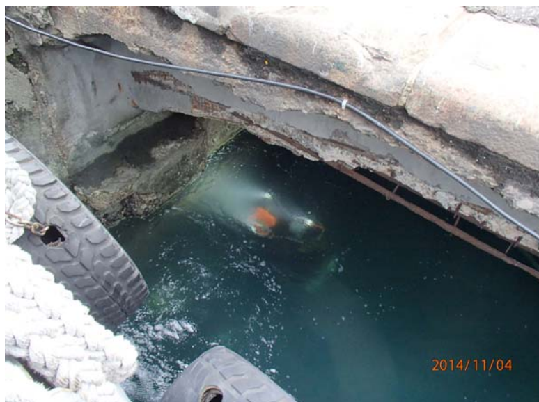
圖 3.45 基隆港西 9 號碼頭岸壁鋼筋混凝土劣化現況
