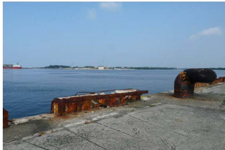
圖 3.23 安平港 3 號碼頭車擋鐵框生銹情形
