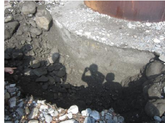
水壓計及鐵架遺失(102年11月27日)
