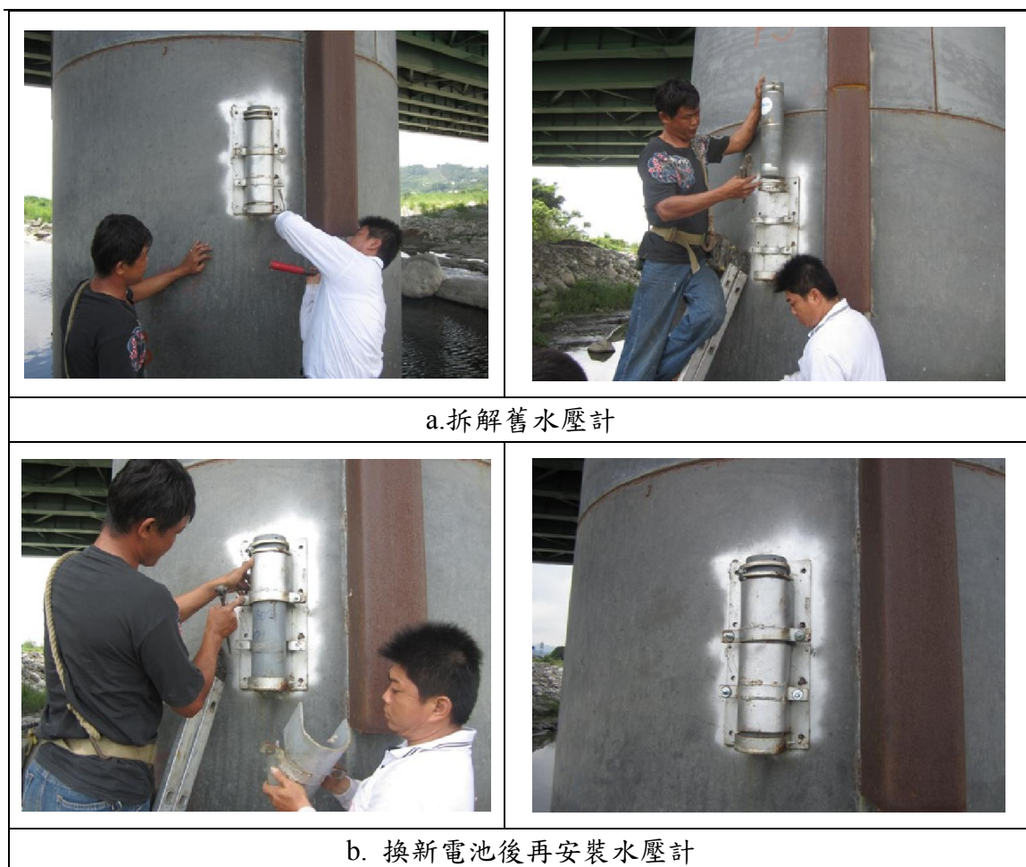
圖 2.11 拆解舊水壓計換新電池後再次安裝(103 年 6 月 20 日)
