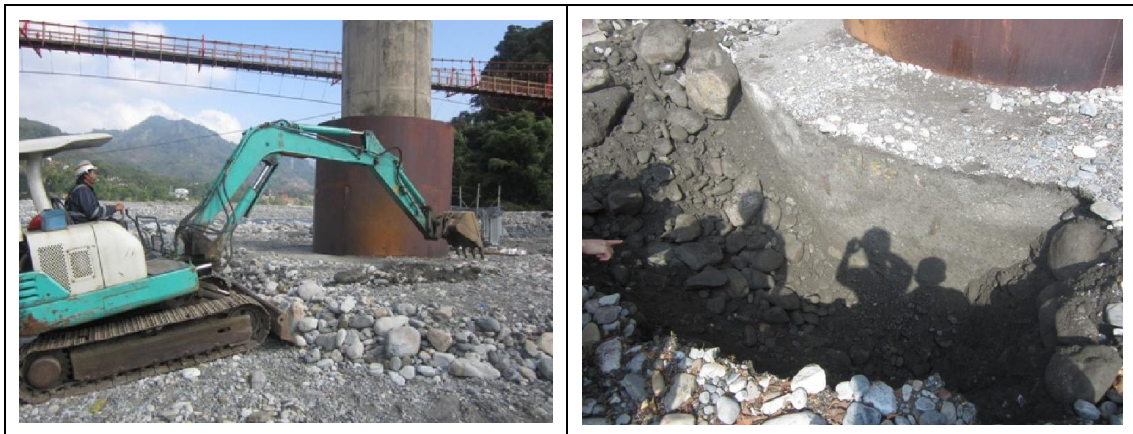
圖 2.8 水壓計及鐵架遺失(102 月 11 月 27 日)
