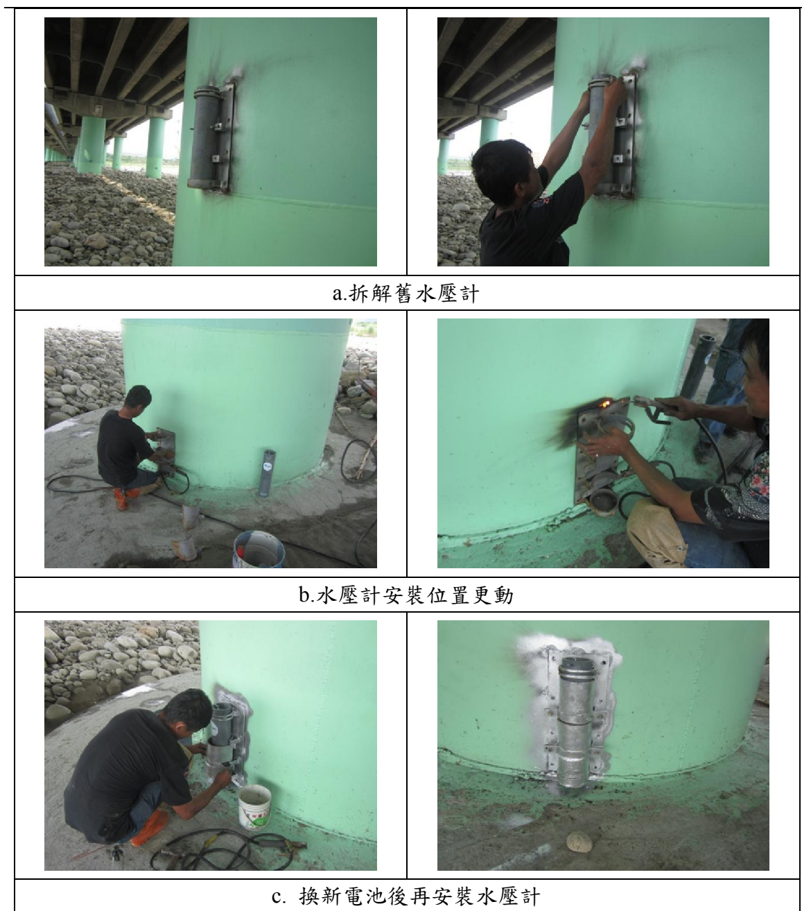
圖 2.20 拆解舊水壓計換新電池降低高程後再次安裝 (103 年 6 月 20 日)
