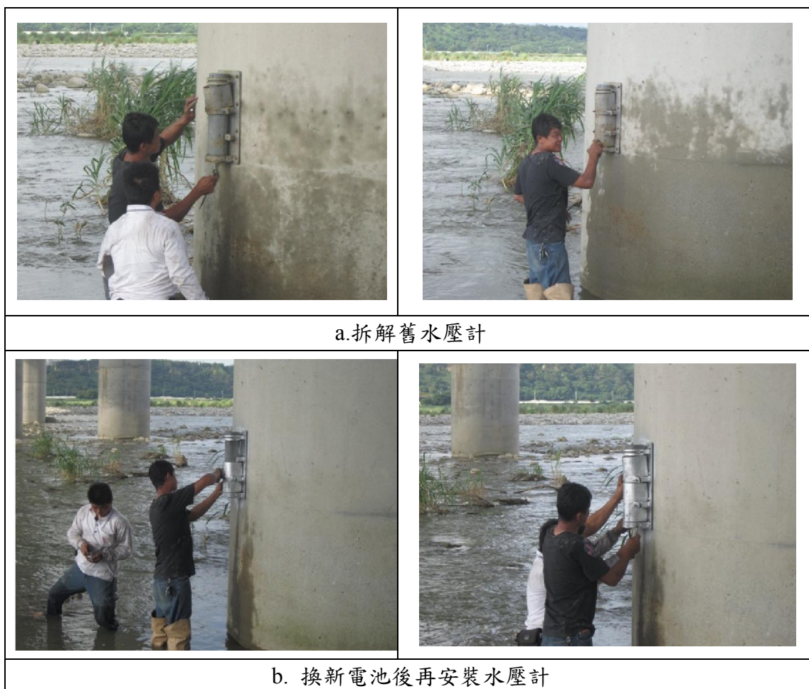
圖 2.22 拆解舊水壓計換新電池後再次安裝(103 年 6 月 20 日)
