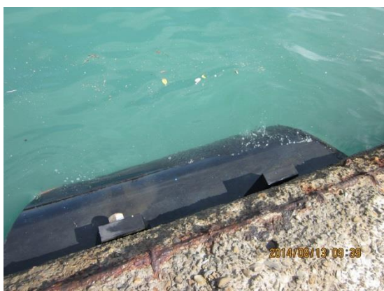
圖 5.31 東 7 號碼頭單元 5 防舷材 螺栓缺損
