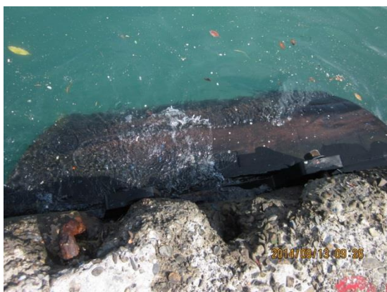
圖 5.29 東 6 號碼頭單元 6 防舷材 螺栓缺損
