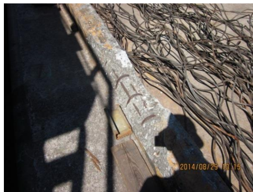
圖 5.42 東 17 號碼頭單元 9 車檔 劣化
