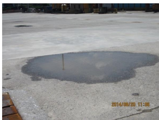
圖 5.43 東 19 號碼頭單元 2 岸肩 沉陷
