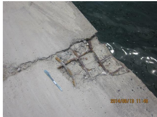
圖 5.24 西 31 號碼頭單元 8 岸肩剝落
