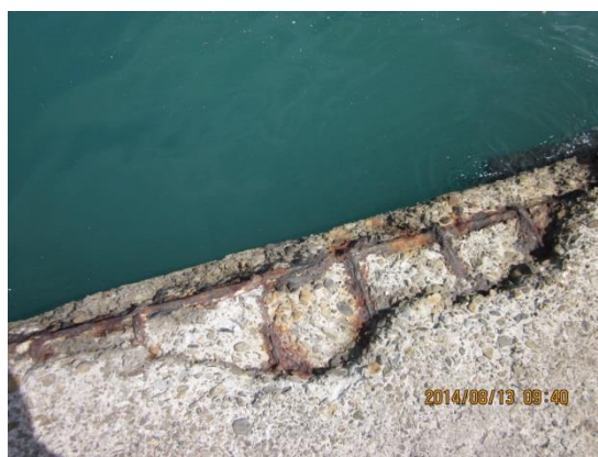
圖 5.32 東 7 號碼頭單元 5 岸肩剝落
