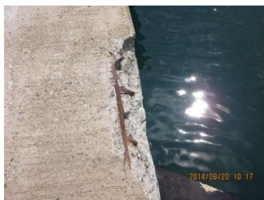
圖 5.44 東 21 號碼頭單元 5 岸肩 剝落
