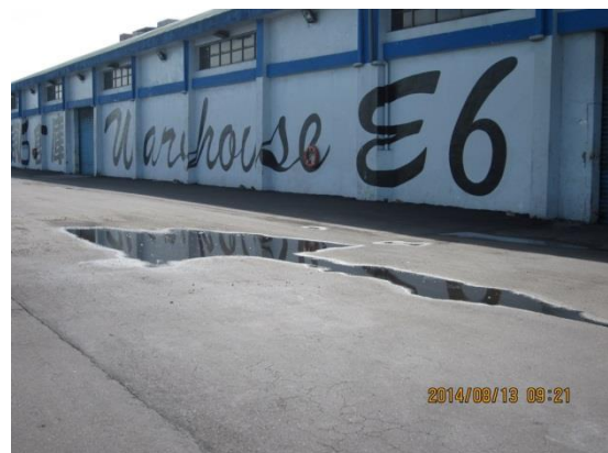
圖 5.28 東 6 號碼頭單元 5 岸肩沉陷
