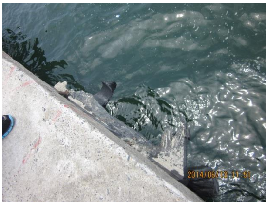
圖 5.25 西 31 號碼頭單元 7 防舷材龜裂破損
