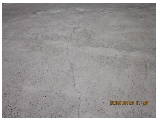
圖 5.45 東防波堤單元 25 裂縫
