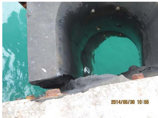
圖 5.20 西 18 號碼頭單元 8 防舷材龜裂破損
