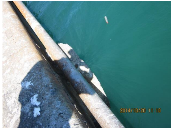
圖 5.18 西 9 號碼頭單元 2 號防舷材龜裂破損
