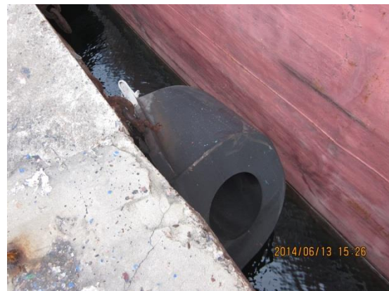
圖 5.26 西 33 號碼頭單元 2 防舷材龜裂破損
