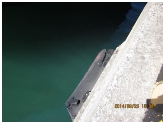
圖 5.41 東 17 號碼頭單元 2 防舷材 表面劣化
