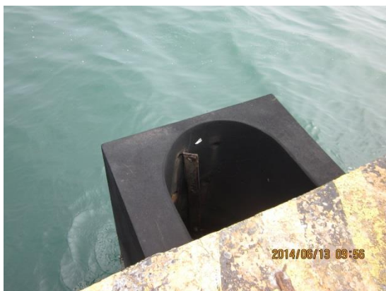
圖 5.21 西 25 號碼頭單元 1 防舷材龜裂破損
