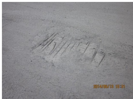
圖 5.22 西 27 號碼頭單元 4 岸肩剝落
