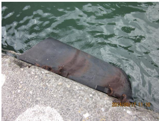
圖 5.19 西 12b 號碼頭單元 5 防舷材龜裂破損
