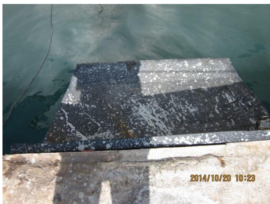
圖 5.27 東 5 號碼頭單元 4 防舷材螺栓缺損
