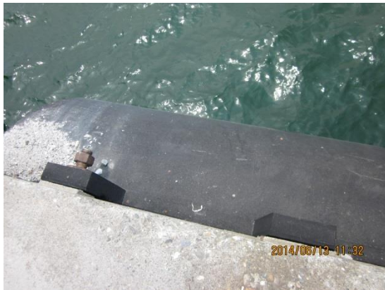
圖 5.23 西 30 號碼頭單元 4 防舷材龜裂破損
