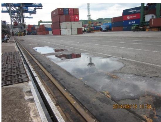
圖 5.33 東 10 號碼頭單元 3 岸肩 沉陷
