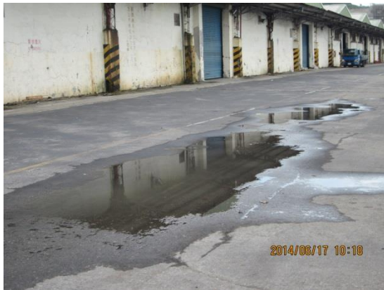
圖 5.17 西 7 號碼頭單元 3 岸肩沉陷
