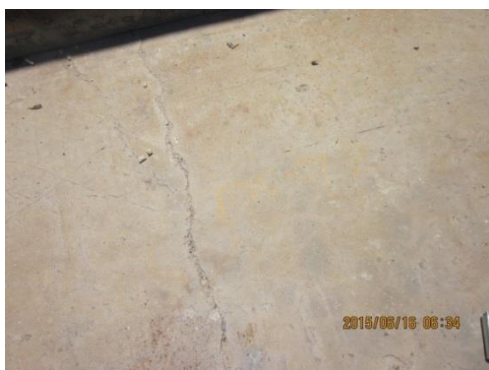
圖 5.101 水頭港區西防波堤單元9 堤頂裂縫
