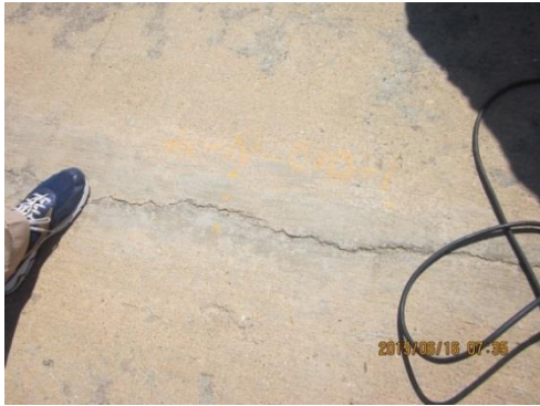
圖 5.95 水頭港區北防波堤單元 10 堤頂裂縫
