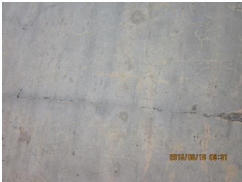
圖 5.97 水頭港區西防波堤單元 8 胸牆裂縫-1
