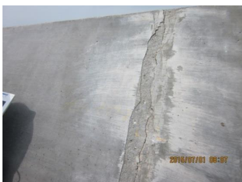
圖 5.103 九宮港區北防波堤單元 28 胸牆裂縫
