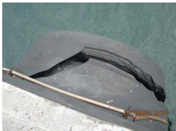
圖 5.116 蘇澳港 11 號碼頭防舷材劣損情形(104.09)
