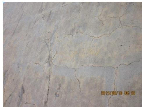
圖 5.100 水頭港區西防波堤單元 9 胸牆裂縫
