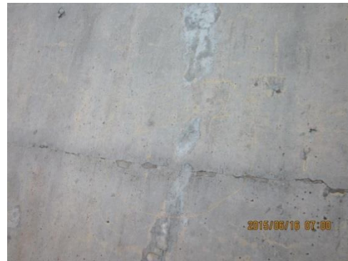
圖 5.98 水頭港區西防波堤單元 8 胸牆裂縫-2
