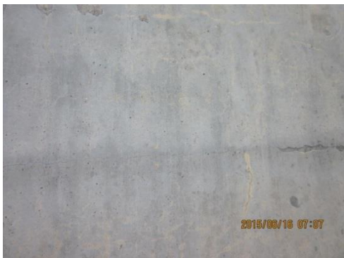
圖 5.99 水頭港區西防波堤單元 8 胸牆裂縫-3
