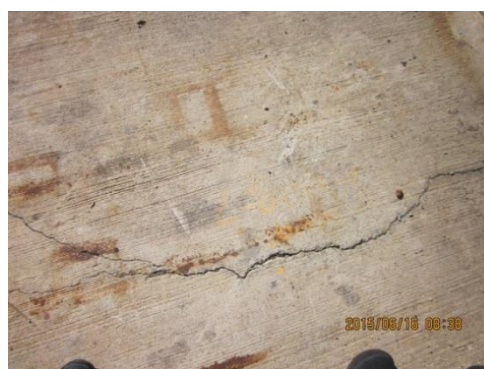
圖 5.104 料羅港區南防波堤單元 13 堤頂裂縫-1
