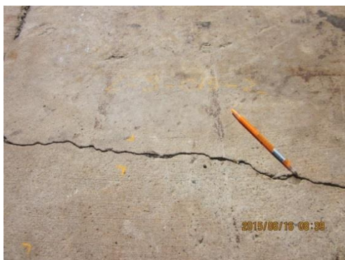
圖 5.105 料羅港區南防波堤單元 13 堤頂裂縫-2
