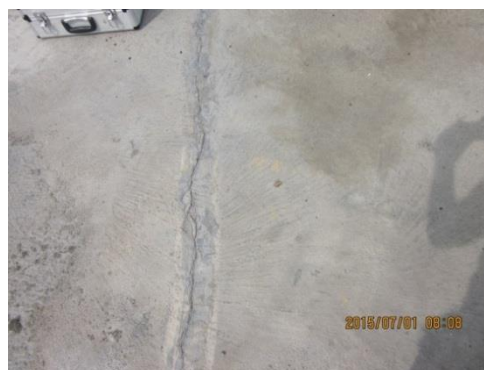
圖 5.102 九宮港區北防波堤單元 28 堤頂裂縫
