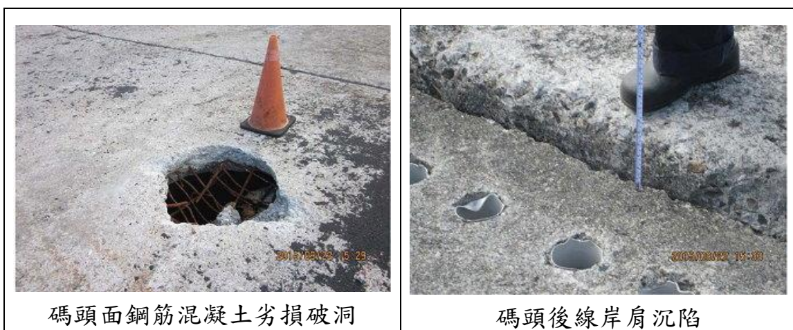
圖 5.122 蘇澳港 13 號碼頭劣損破洞沉陷照片(104.09)
