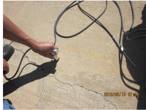
圖 5.96 水頭港區北防波堤單元 34 堤頂裂縫
