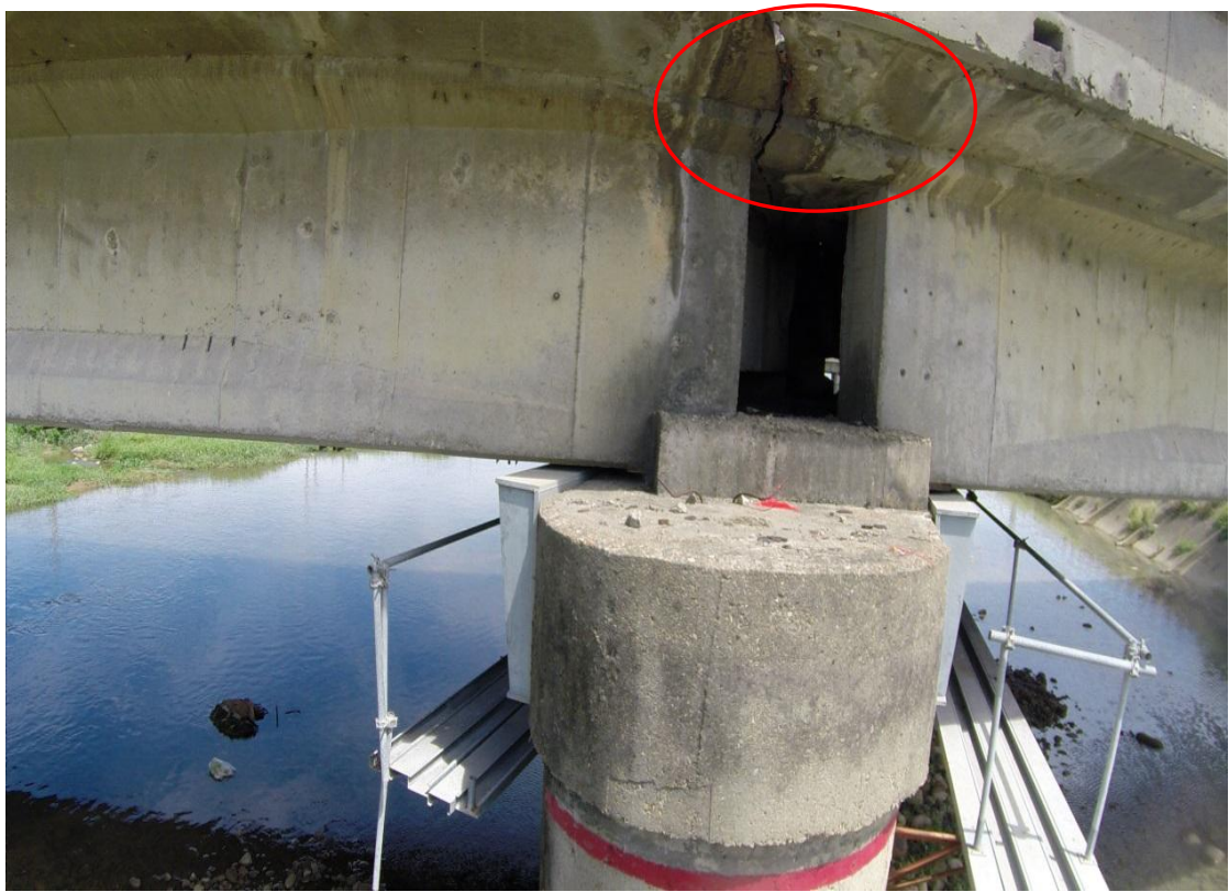
圖 6.1 新大崛溪橋混凝土剝落原圖
