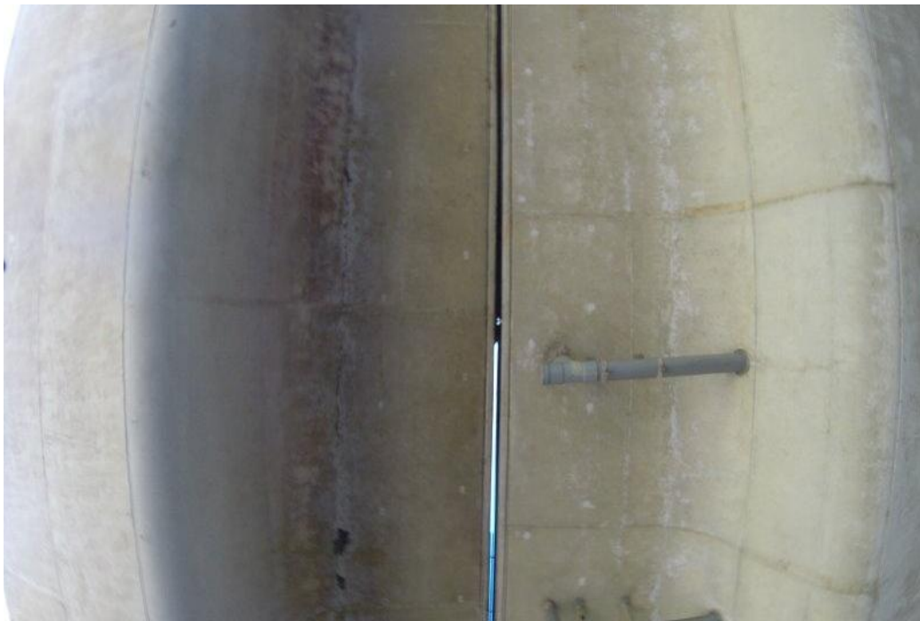
圖 5.16 S 型路線下拍攝之台 61 號快速道路橋底照片
