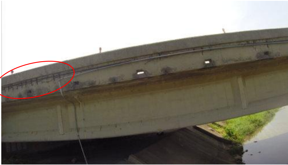
圖 6.3 新大崛溪橋鋼筋外露原圖
