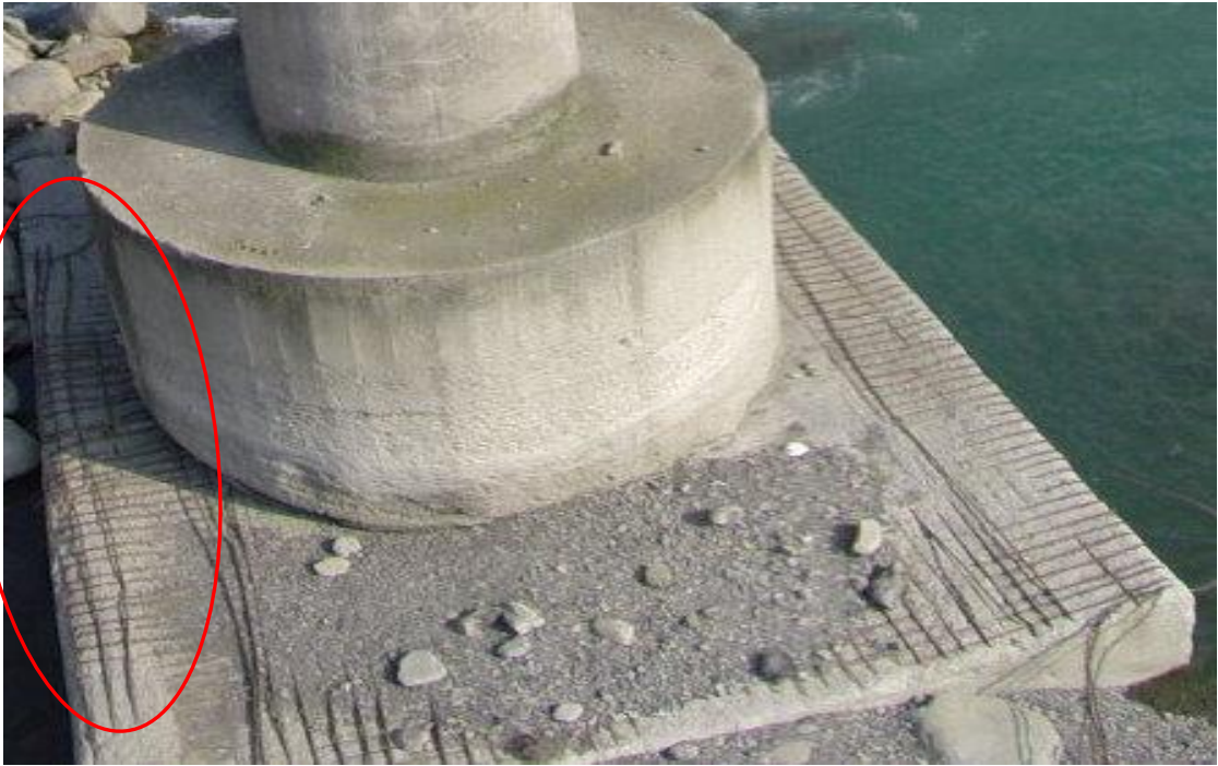
圖 6.5 內灣大橋鋼筋外露原圖
